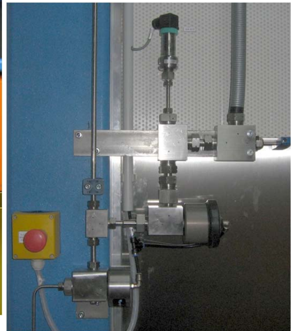
Obr. 94. Bezpečnostní ventil umístěný za dveřmi v prostoru s roboty.
