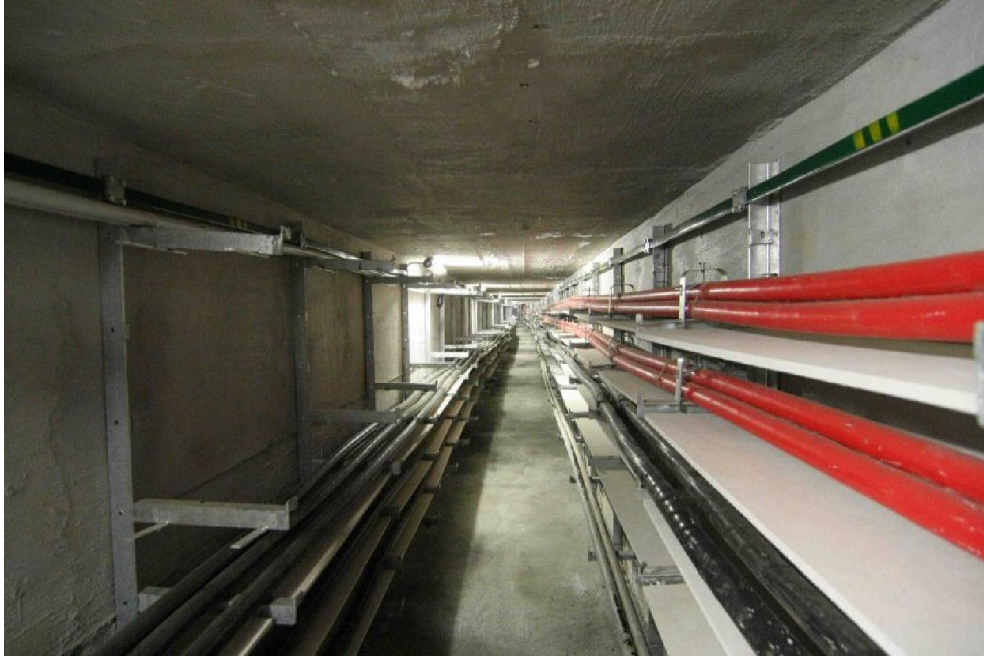
Obr. 4 kabelový kanál -Praha Klárov. [10]
