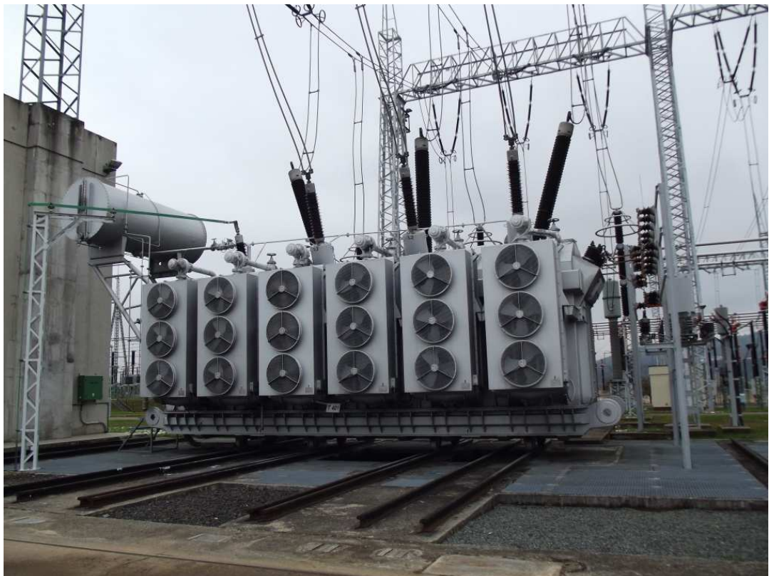
Obr. 1 Autotransformátor 400/121 kV – rozvodna Přeštice
