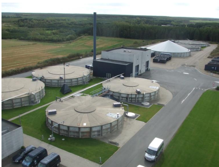
Obr. 2.8 Přípravné a skladovací nádrže v BPS poblíž města Ulfborg v Dánsku
