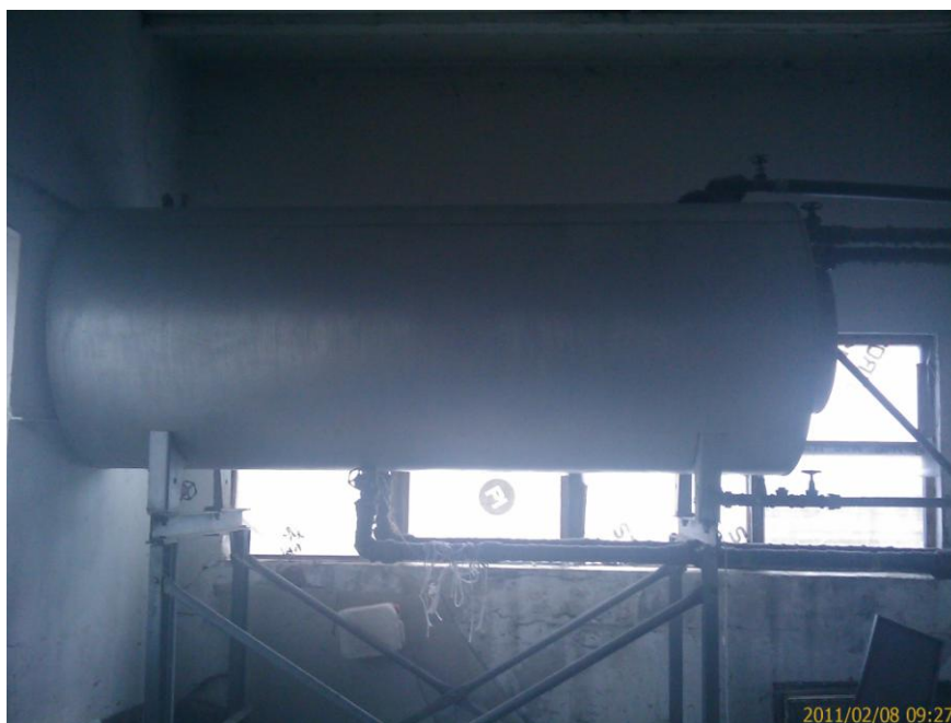
Obr. 4.11 Nádrž s předehřátou vodou
