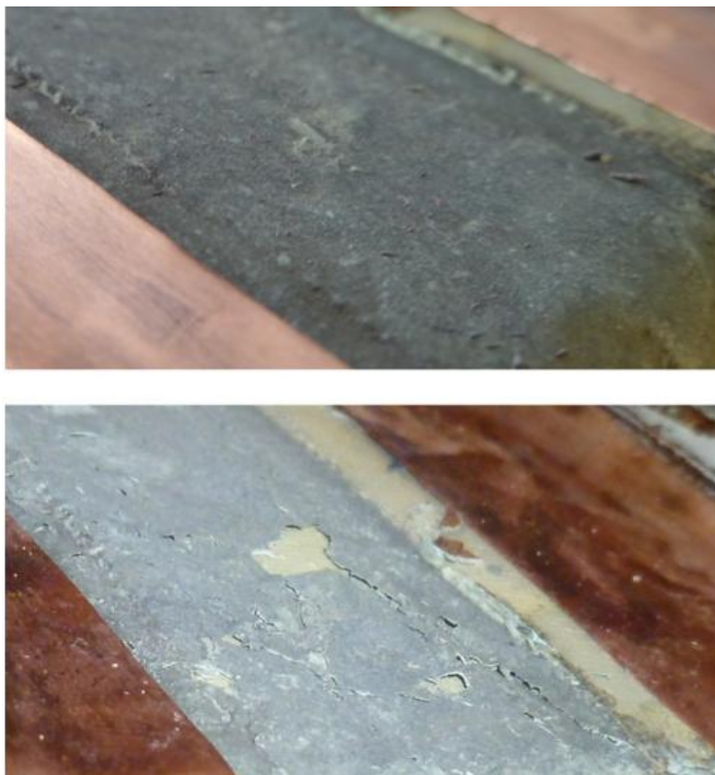
Obr. 11 Změna struktury povrchu izolačního systému při dlouhodobém působení čisticího prostředku Kempt II.
