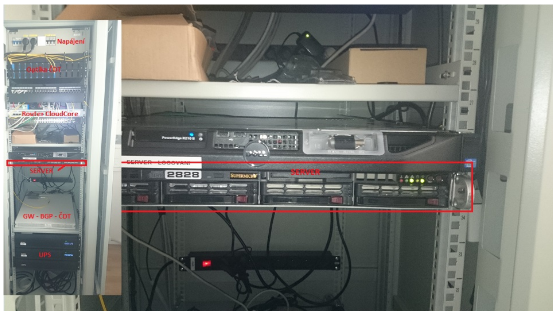
Obrázek 65: Umístění serveru v racku PlzenecNET, o.s.
