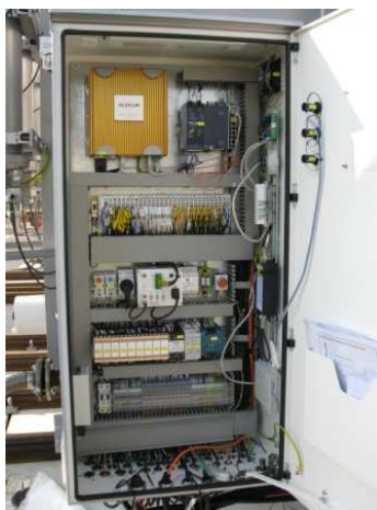
Obr. 10: Skříň monitorovacího systému transformátoru
