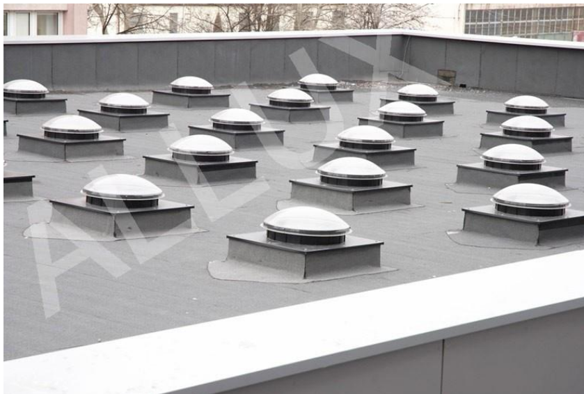
Obr. 22 Střešní části světlovodů Allux ( http://www.allux.cz/svetlovody/svetlovod014.jpg )
