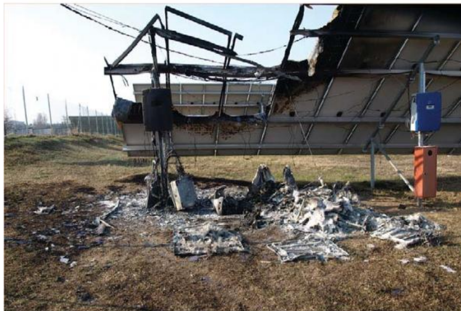
Obr. 33: Poškození PV panelu bleskem [32]
