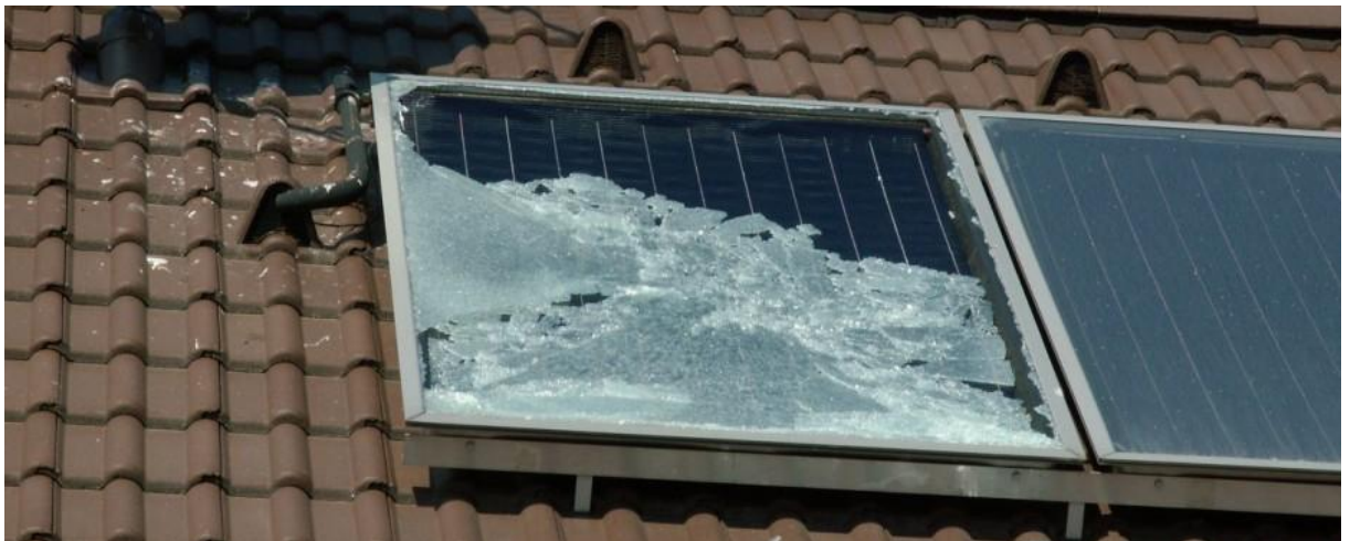
Obr. 51: Rozsypané bezpečnostní sklo PV panelu [64]
