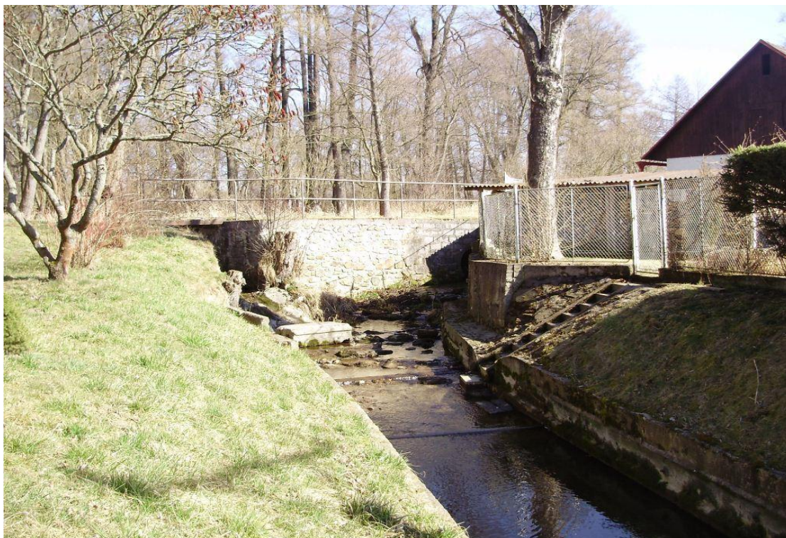
Obr. č. 8 , přepadové odvodňovací koryto náhonu, které plní také funkci protipovodňové ochrany, Foto T. Ulč 2014
