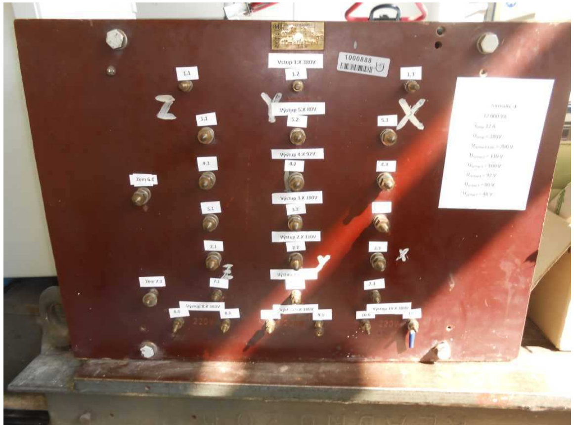
Obrázek 31 Foto prvního transformátoru
