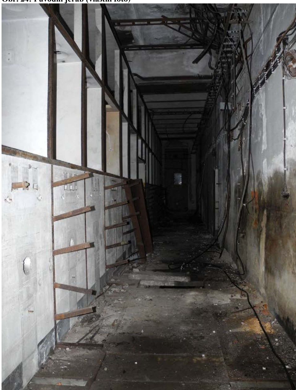
Obr. 25: Blokovaná rozvodna 5 kV (vlastní foto)
