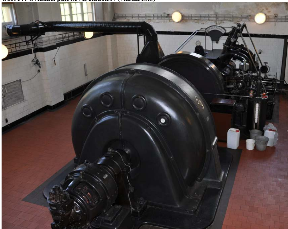
Obr. 38: Soustrojí MVE Rudolfov (vlastní foto)
