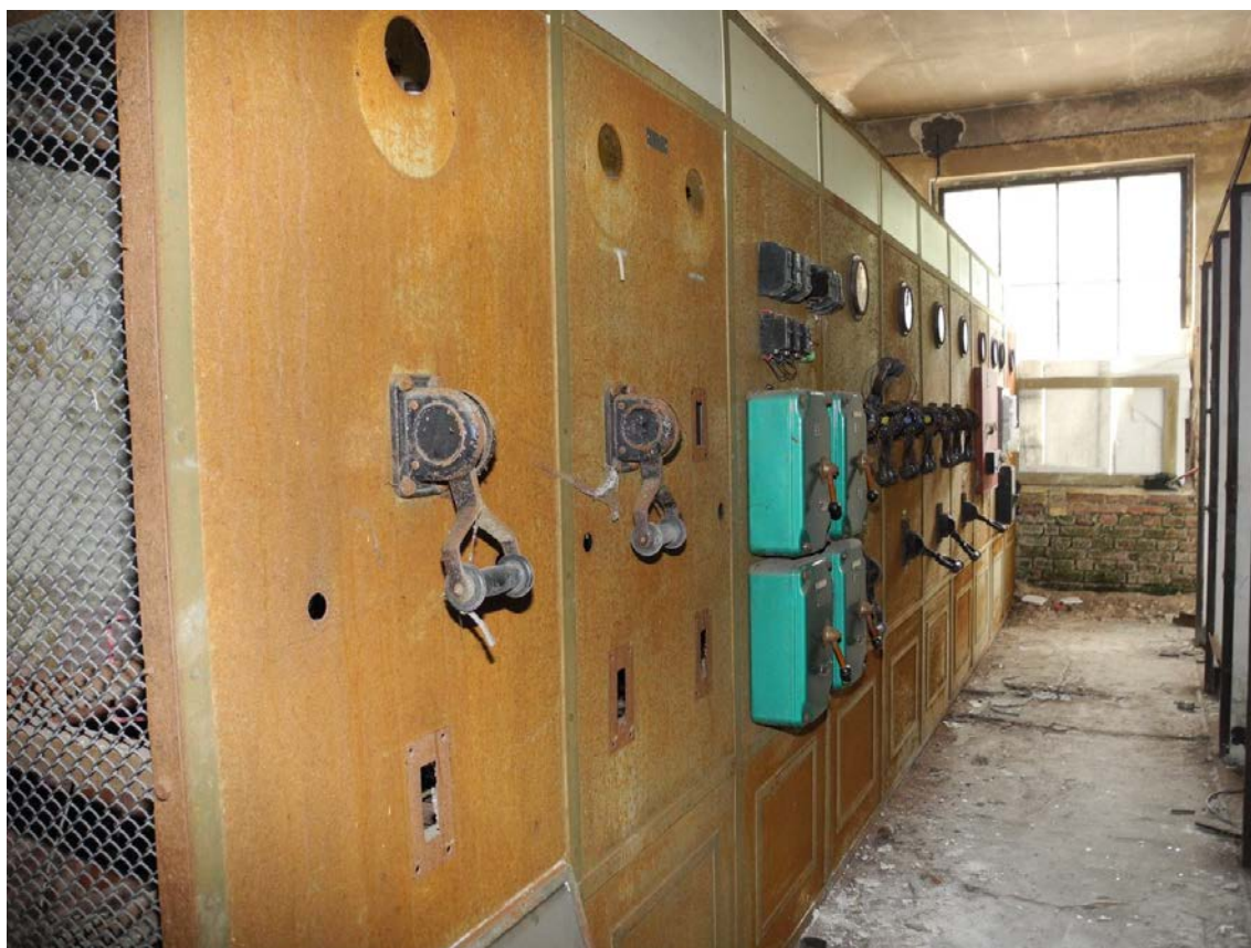
Obr. 22: Rozvodna vlastní spotřeby (vlastní foto)
