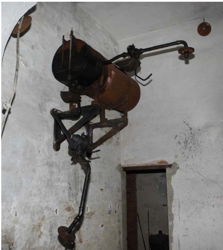
Obr. 26: Konzervátor transformátoru vlastní spotřeby (vlastní foto)
