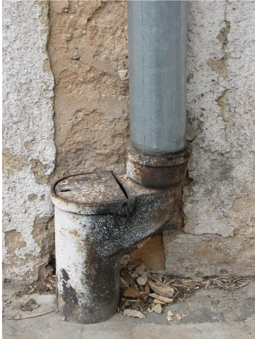
22. Nevhodné ukončení okapu – litinový gajgr[2]
