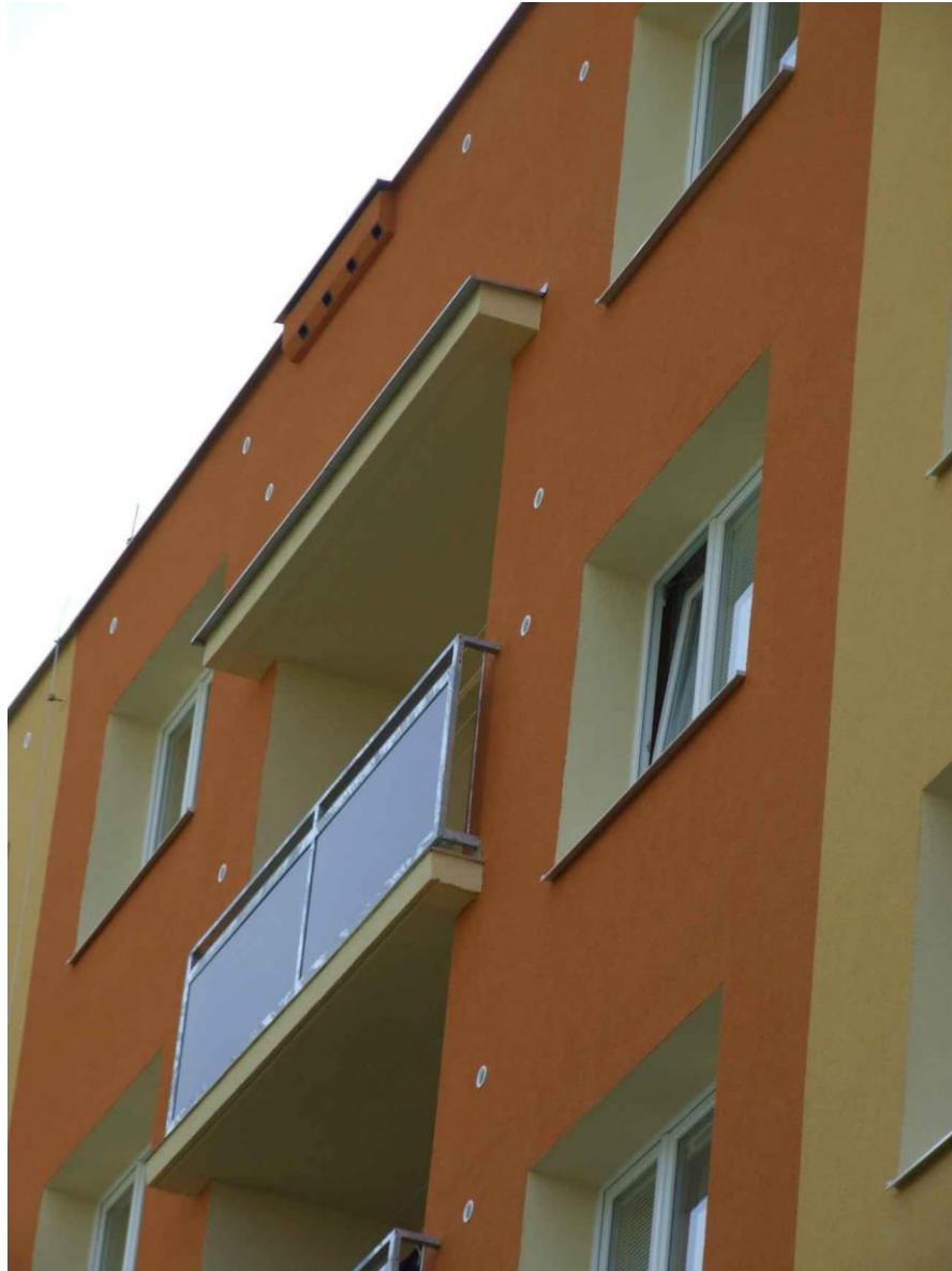
10. Budka pro rorýse a větrací otvory osazené koncovkou s mřížkou[2]
