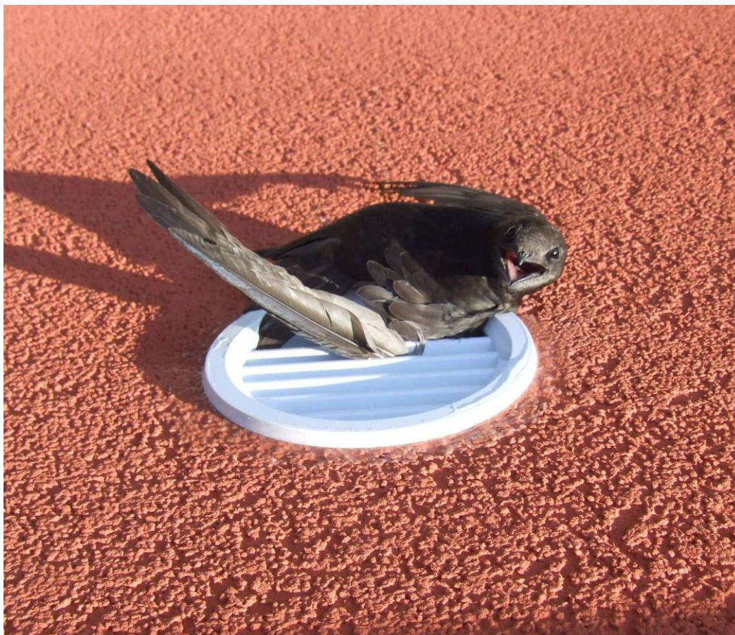
9. Rorýs uvězněný v nevhodně řešené mřížce[2]
