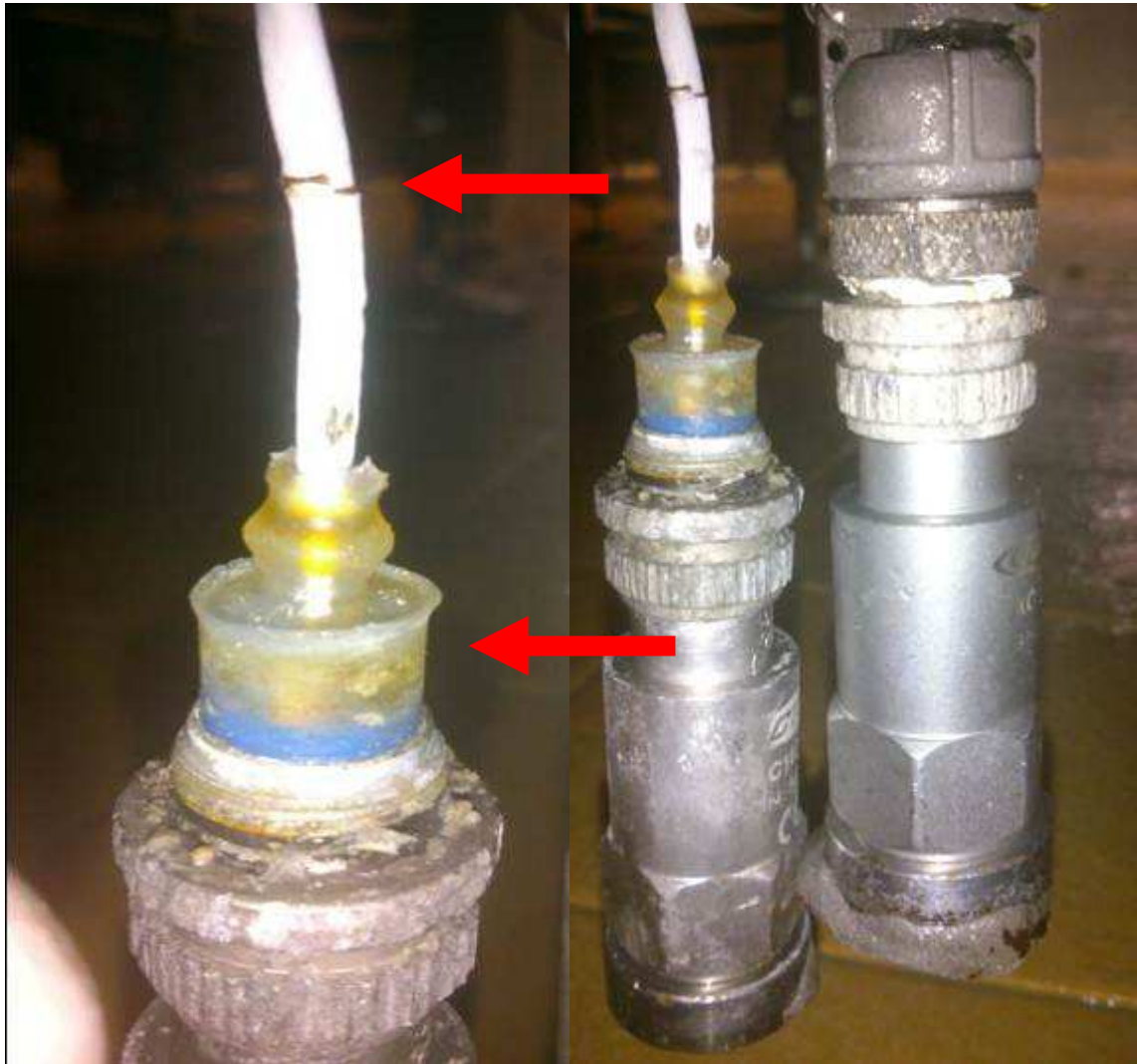
Obr7.10 a 7.11. Mechanické poškození kabelu, silikonová ochrana spoje kabel-konektor
