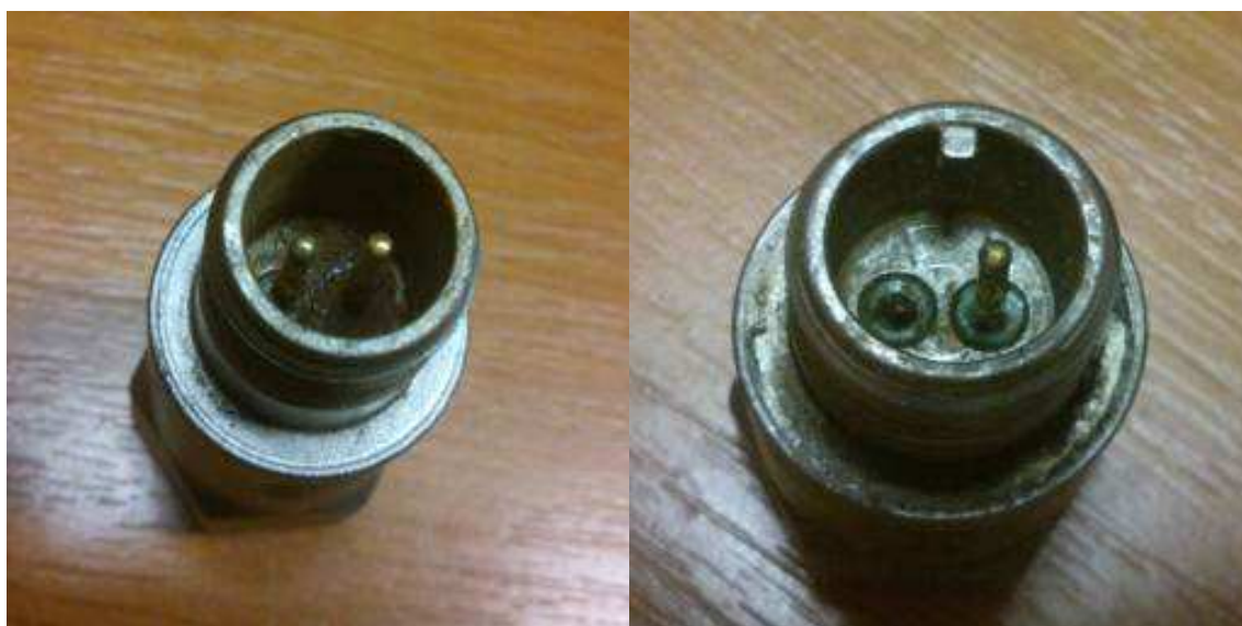
Obr.7.7. a 7.8. Snímače po vniku sanitace dovnitř
