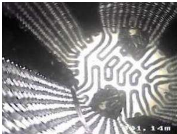
Obr. 3.8 Cizí těleso uvnitř výměníku
