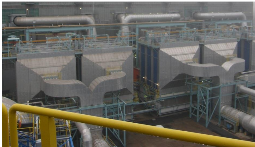
Obr. 3 - elektrostatické odlučovače bloku 2,3 - Elektrárna Tušimice II
