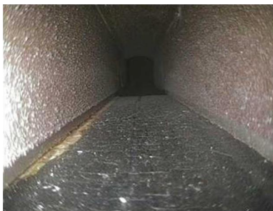
Obr. 3.16 Počáteční stádium poškození erozí izolace vlivem vibračního jiskření (převzato z [49])
