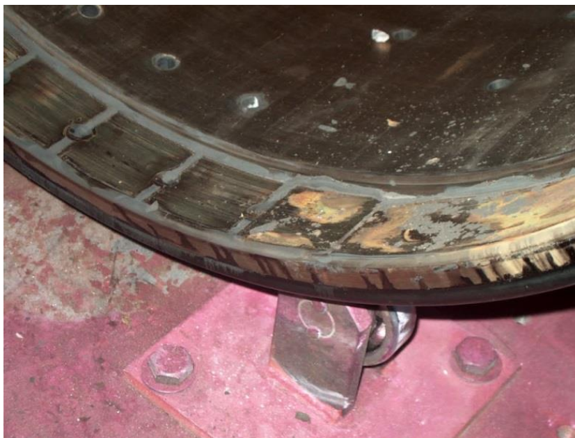
P 4.1 Znečištěné ventilační otvory nemagnetické obruče rotoru [53]
