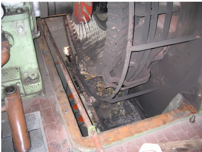
P 6.2 Přerušeni nulového vývodu statorového vinutí turbogenerátoru - pohled statorové vinutí [53]
