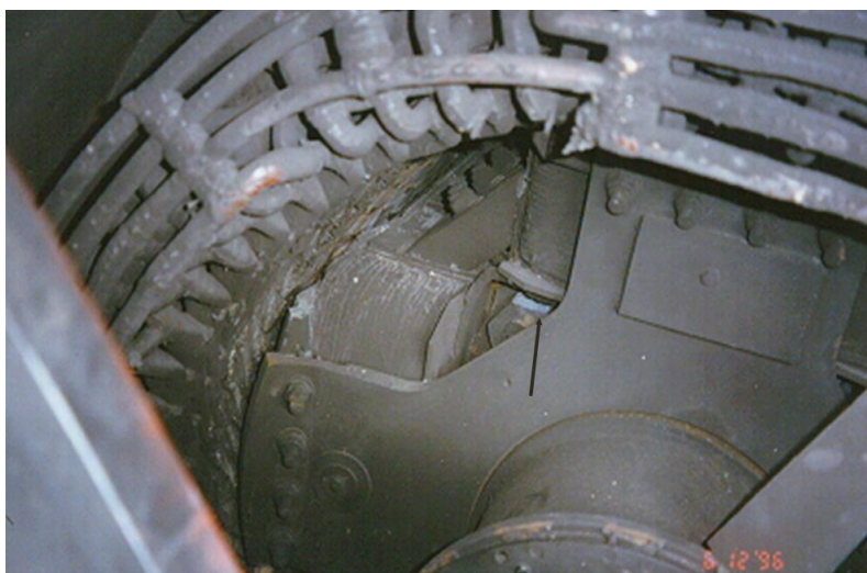
P 5.3 Uvolněný šroub se dostal do vzduchové mezery a způsobil zadření stroje (převzato z [43])
