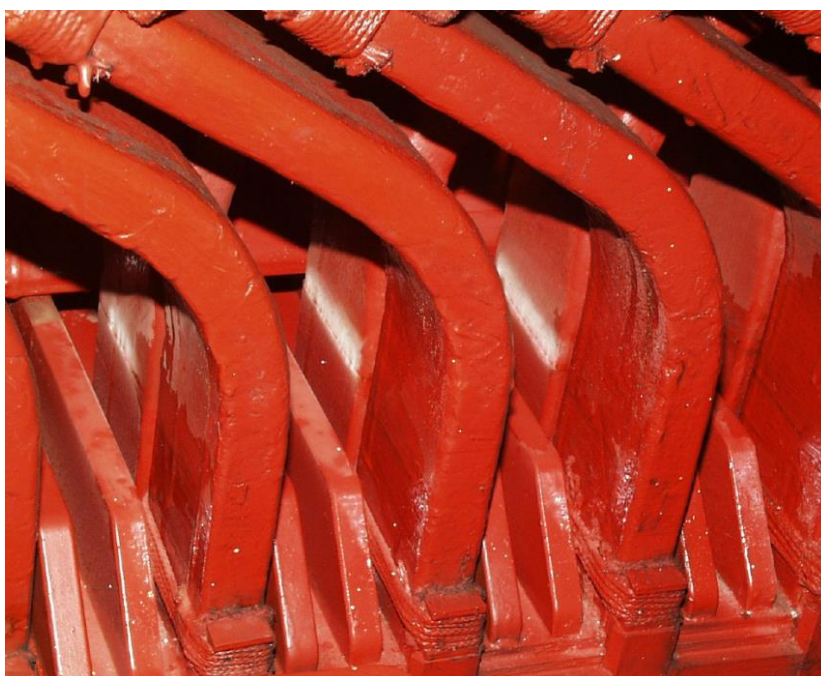
P 1.4 Částečné výboje na ochranné polovodivé vrstvě (převzato z [42])
