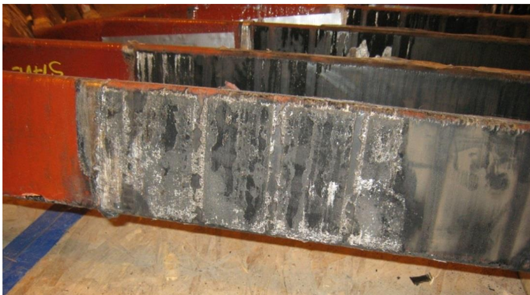
P 1.6 Tyč vinutí poškozená vibračním jiskřením (převzato z [43])
