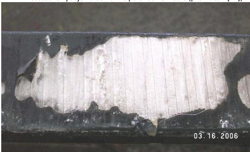
P 1.5 Degradace a blednutí izolace v drážce vlivem působení částečných výbojů a ozonu (převzato z [49])
