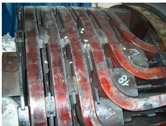
P 3.2 Znečištění čelních prostor vinutí rotoru prachem pod obručemi turbogenerátoru [53]
