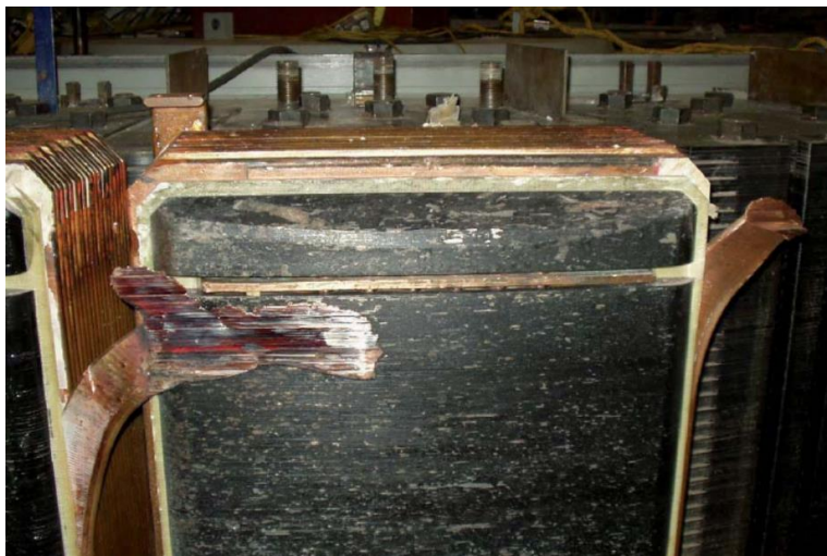
P 5.2 Poškození cívky pólu hydrogenerátoru (převzato z [41])
