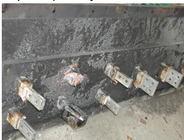
P 6.1 Přerušení nulového vývodu statorového vinutí turbogenerátoru - pohled na průchodky vývodů [53]
