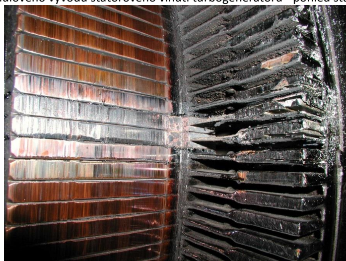
P 6.3 Mezilamelový zkrat na komutátoru kotvy budiče hydrogenerátoru [53]
