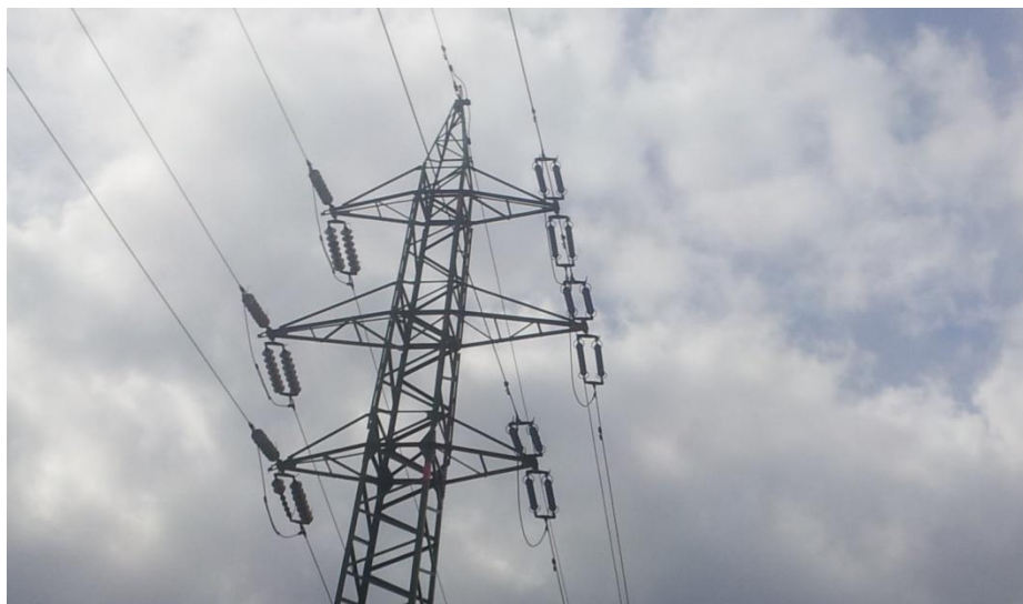
Obr. 1.4 Stožár venkovního vedení přenosové soustavy
