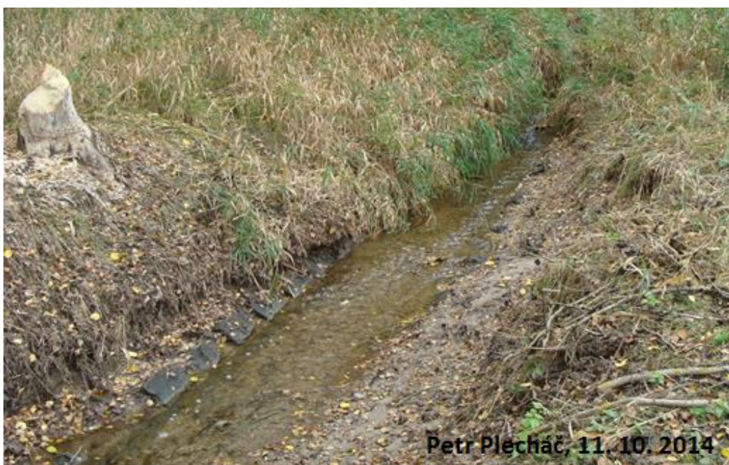
Obr. 39: Obrázek zničené bobří hráze a pozůstatek sedimentů, 11. 10. 2014
