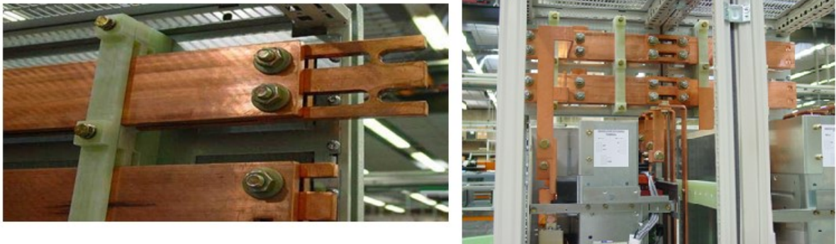
Obrázek 17: realizace DC sběrnice ve skříně S120 [8]
