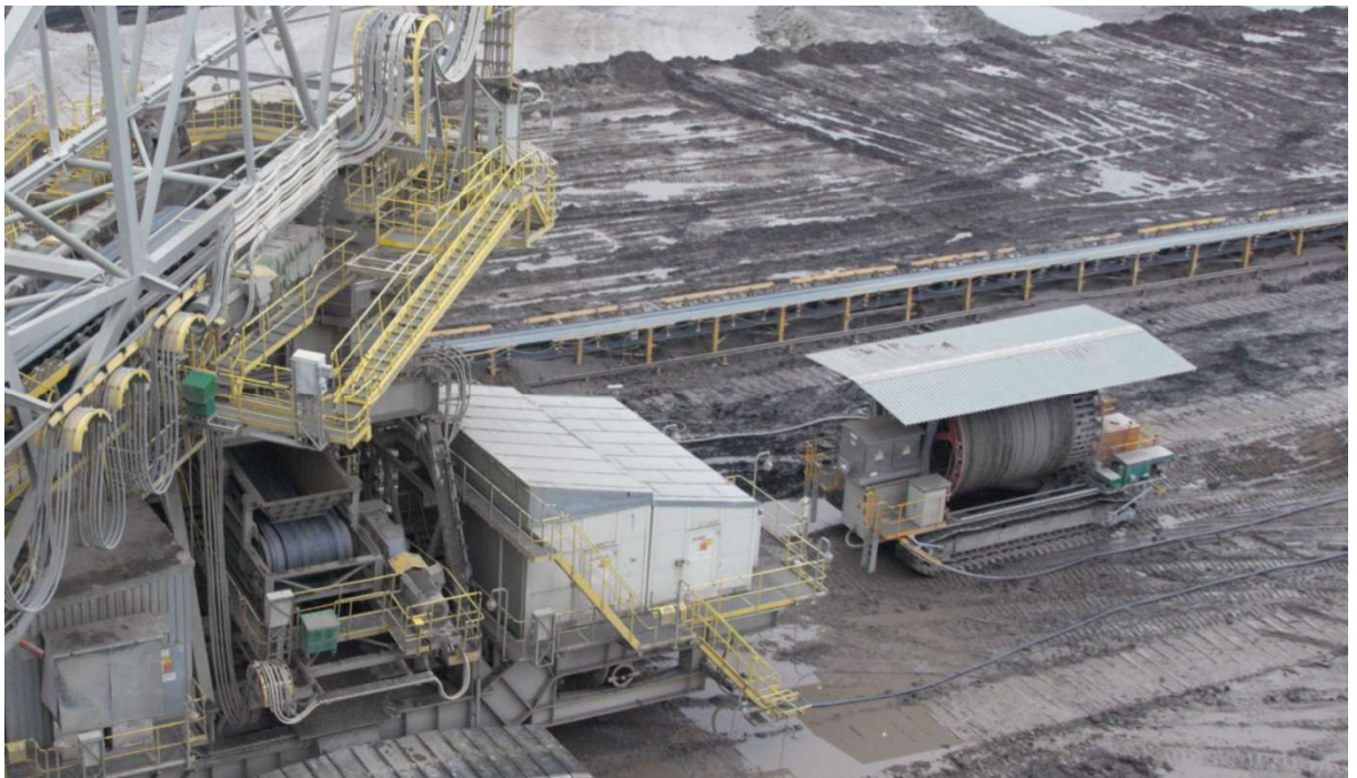
Obrázek 6: Fotografie kabelového vozu s podpěrným vozem
