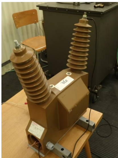
Obr. 4-5: Zkoušený objekt transformátor VTDO 25
