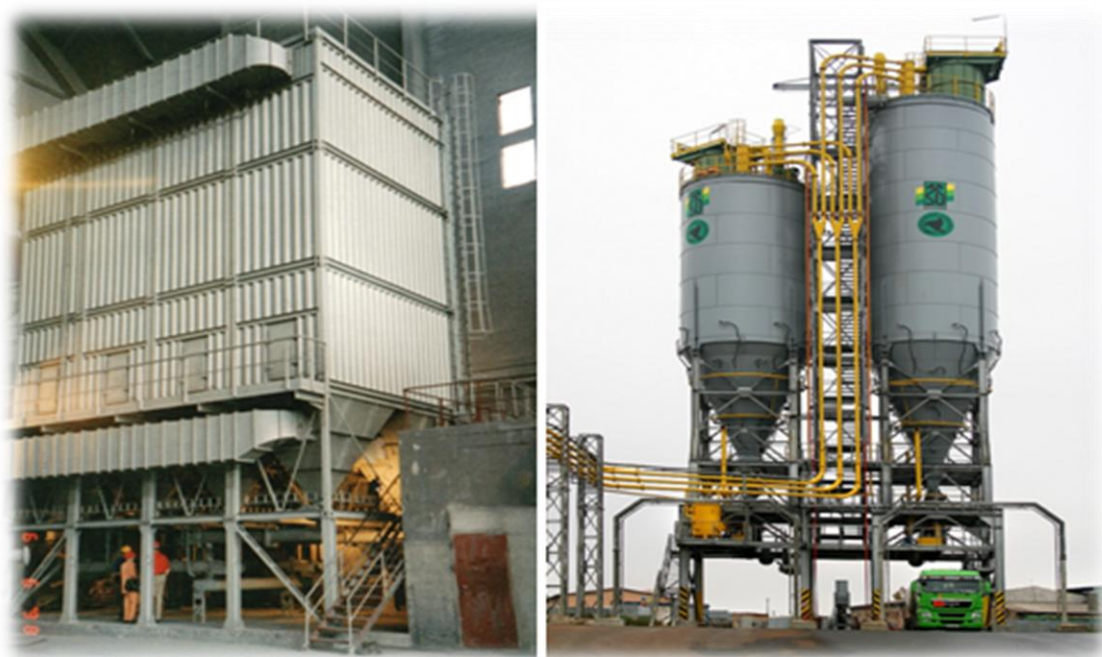
Obr. č. 6: Filtrační jednotka a sila na skladování multiprachu
