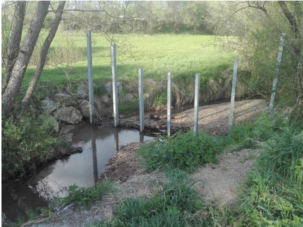
Obr. č. 24 - Konstrukce protipovodňové ochrany na potoce Mariatrosterbach
