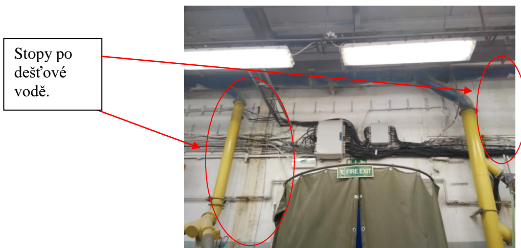
Obr. 2.4.4.2-1 Pohled na rozvodové skříně
