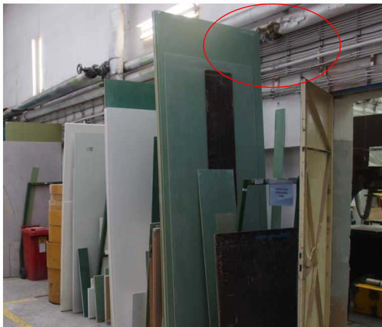
Obr. 2.7.1.2 -3 Poškození izolace vlivem skladování
