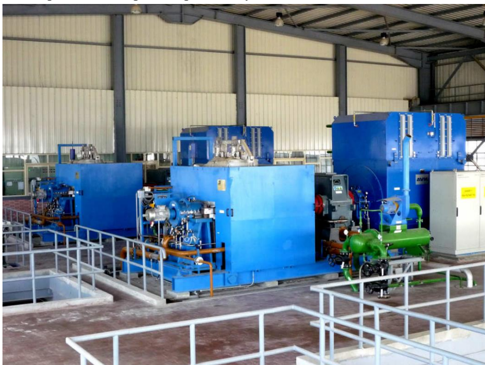
Obrázek č. 2 – Turbínové zařízení s výkonem 2 x 8 MW, Nobarria Egypt [18]
