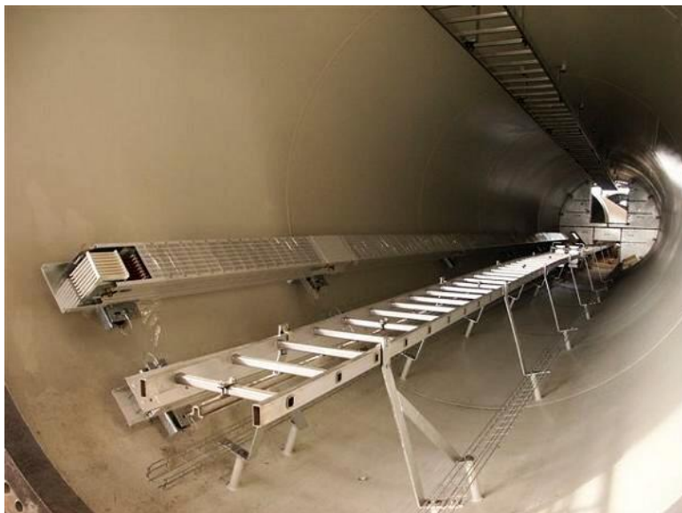
Obrázek 2.3: Vybavení segmentu stožáru žebříkem, kabelovými lávkami a výkonovými kabely [11]
