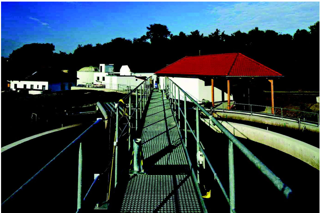
Obrázek č. 31 – Objekt dmychárny a nádrž simplex
