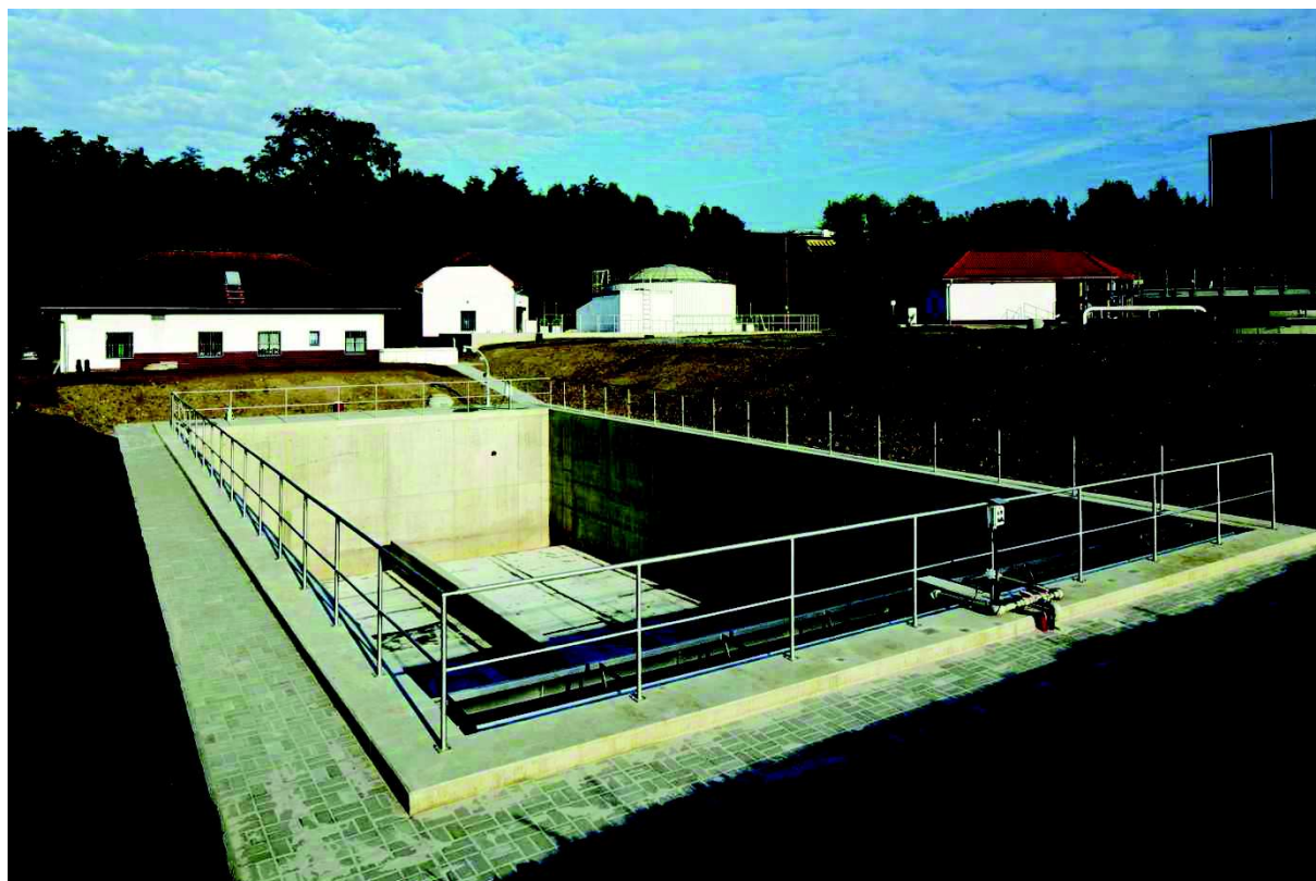
Obrázek č. 34 – Dešťová retenční nádrž
