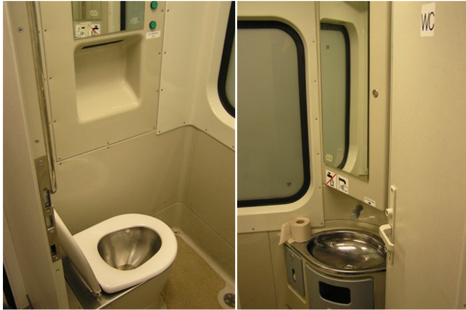
Obrázek 16: WC s vakuovým odsáváním.
