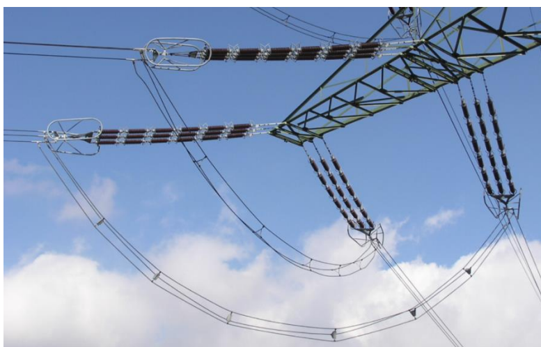
Obr. 4: Detail transpozice fázových vodičů na stožáru typu Dunaj [2]
