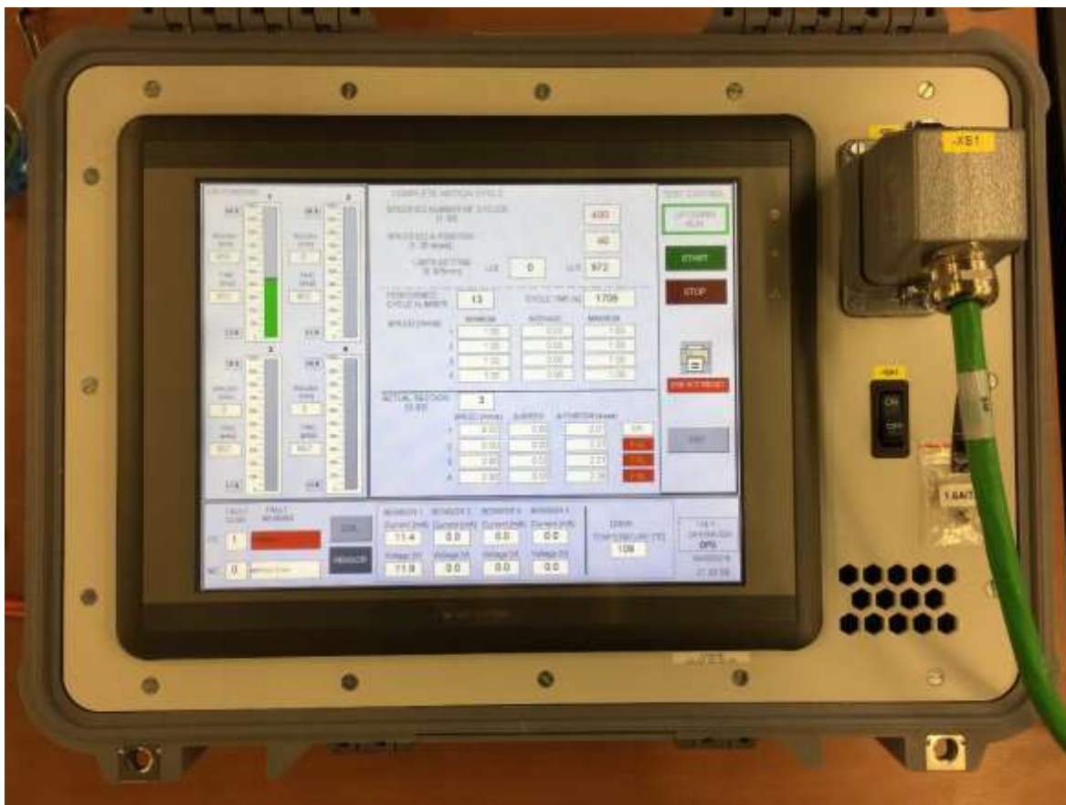
Obr. 4 – Přenosné ovládací zařízení (HMI) při provozu
