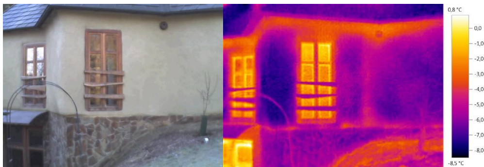
Obrázek 2: Příklad tepelného mostu měřeného objektu z exteriéru
