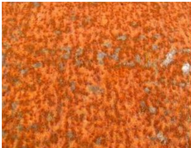
Obr. 4 Napadení oceli rovnoměrnou korozi [16]
