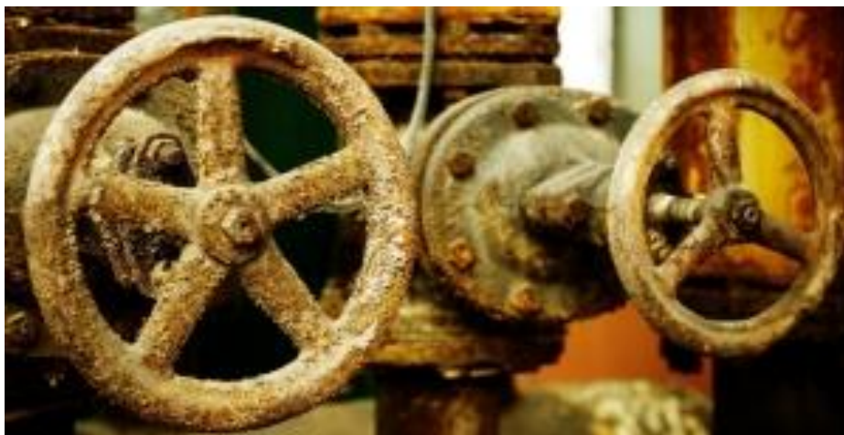
Obr. 10 Regulace potrubí a přírubové spoje zasažené MIC [3]
