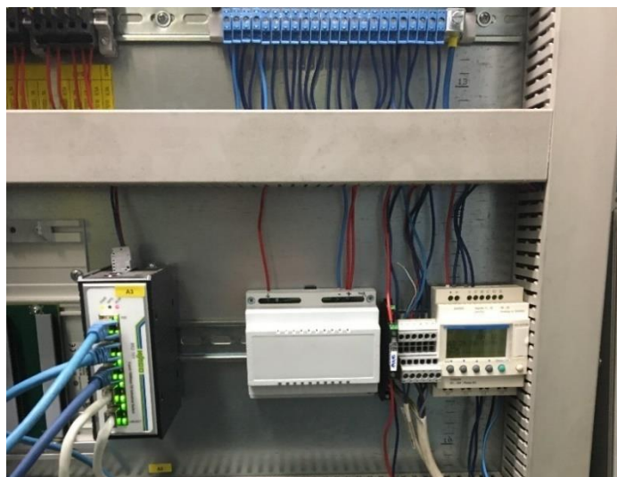
Obrázek 12 – Arduino v rozvodné skříni [zdroj: autor]
