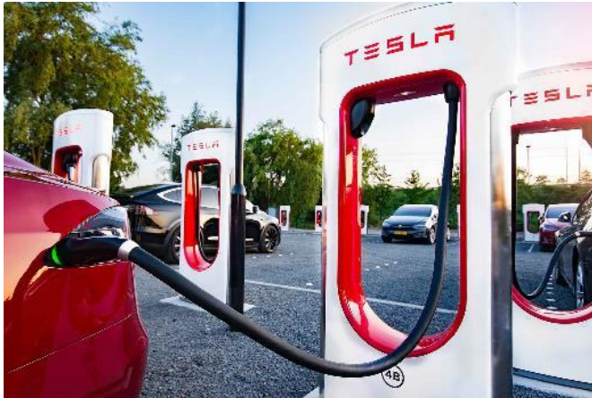
Obr. 37: Nabíjecí stanice pro elektromobil [41]
