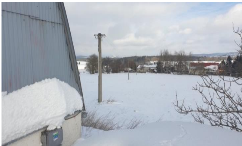
Obr. 1.10 – Přechod kabelu na venkovní vedení (AlFe lana), které vede k trafostanici na začátku vesnice
