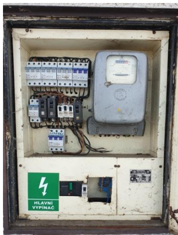
Obr. 1.8 – Podružný rozváděč pro dílnu (elektroměr není zaplombovaný).
