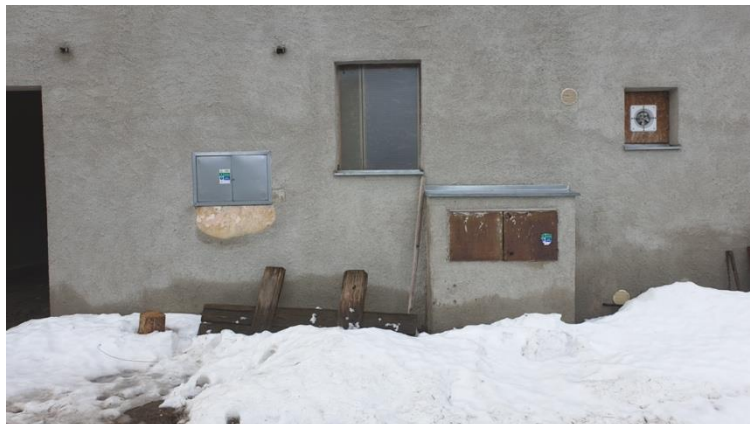
Obr. 1.24 – Podružný rozváděč (vlevo) a rozpojovací jističí skříň ve zděném pilíři (vpravo)
