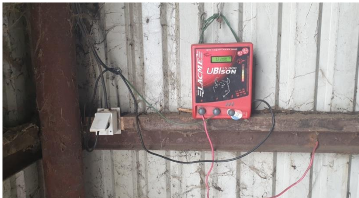
Obr. 1.20 – Jednofázová zásuvka, určená pro napájení elektrického ohradníku
