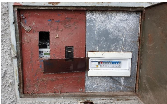
Obr. 1.4 – Elektroměrový rozváděč pro dolní kravín
