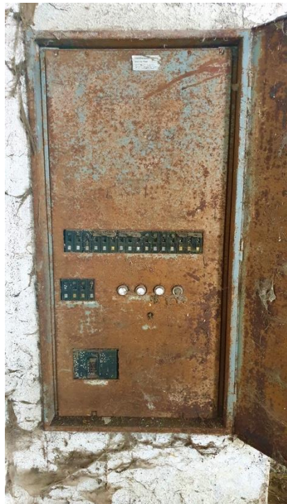
Obr. 1.19 – Podružný rozváděč ve stáji OMD
