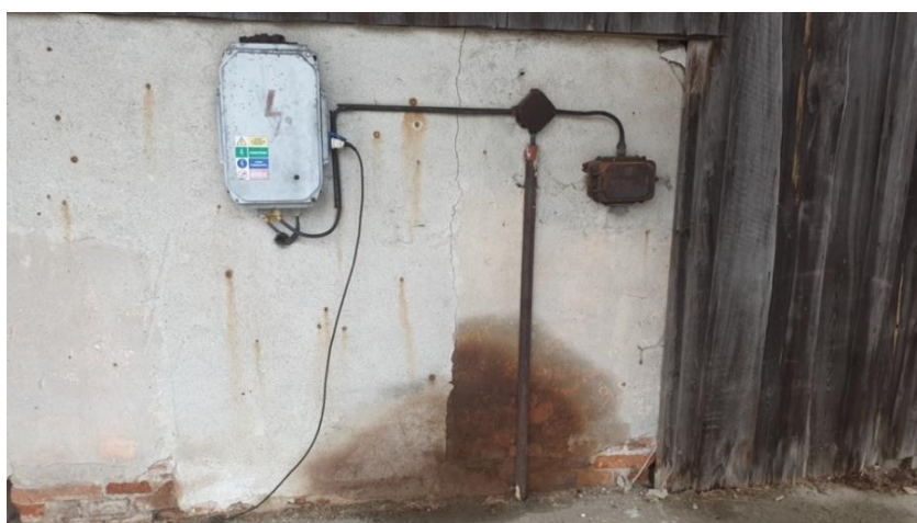
Obr. 1.26 - Podružný rozváděč s třífázovou zásuvkou
