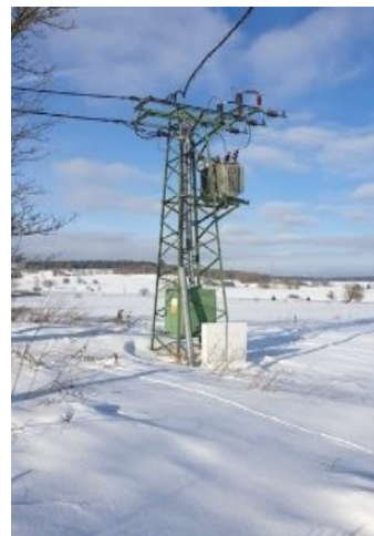
Obr. 1.11 – Elektroměrový rozváděč u trafostanice
