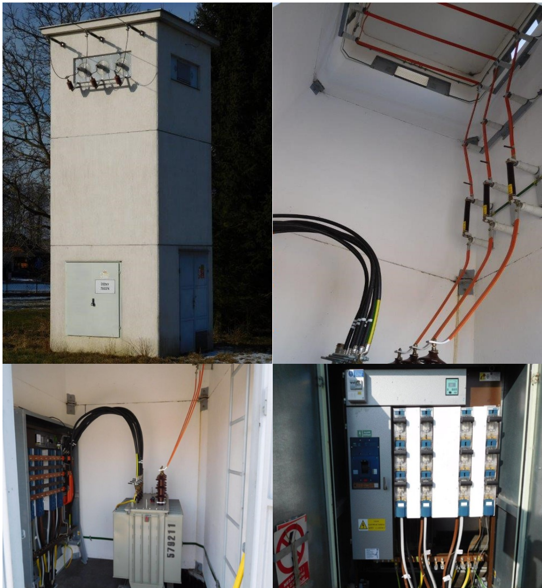
Obr. 2.18 - Věžová trafostanice s venkovním přívodem VN a kabelovými vývody NN, [Zdroj: Archiv autora]
