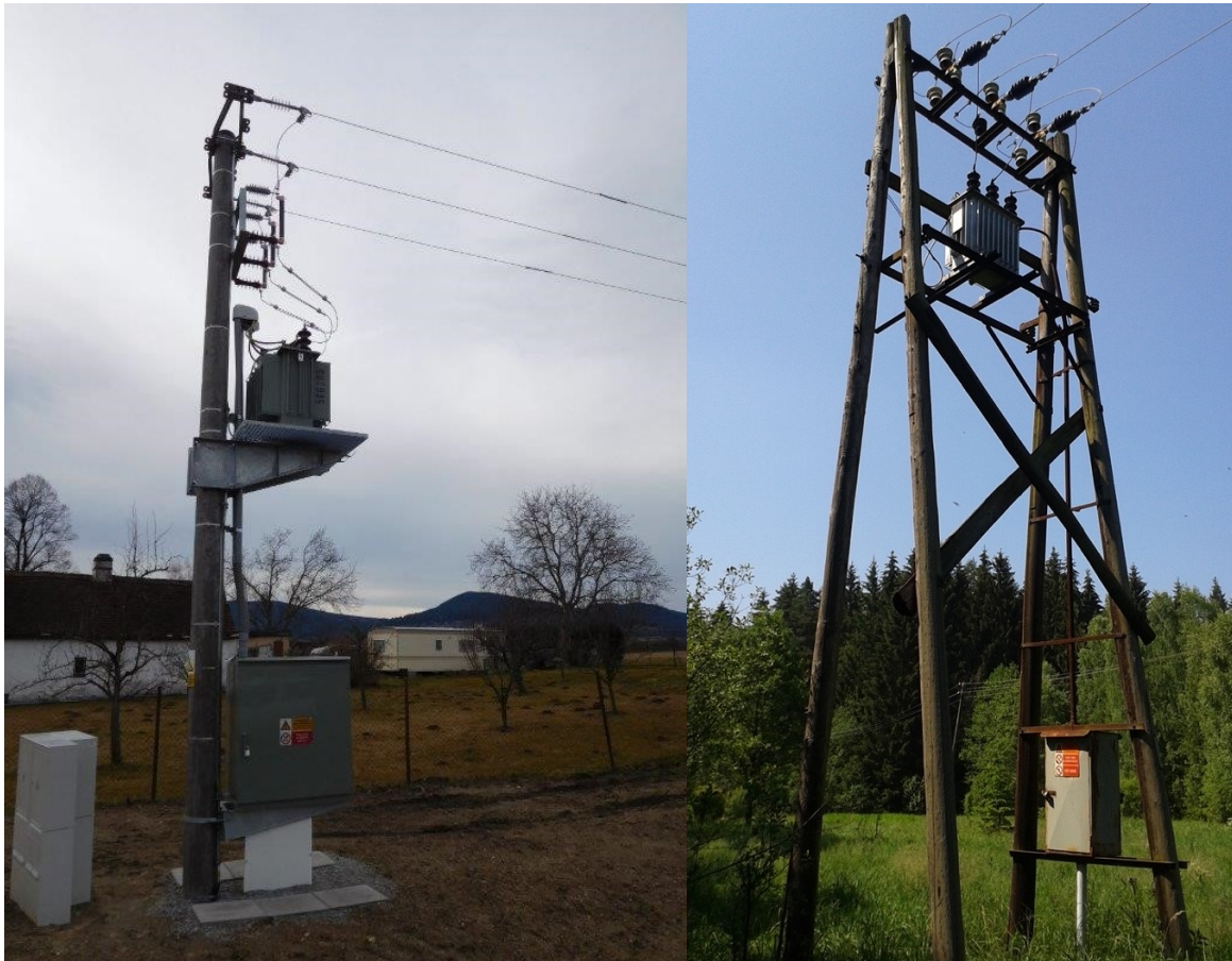
Obr. 2.16 - Sloupová distribuční trafostanice a historická trafostanice na dřevěných sloupech, [Zdroj: Archiv autora]
