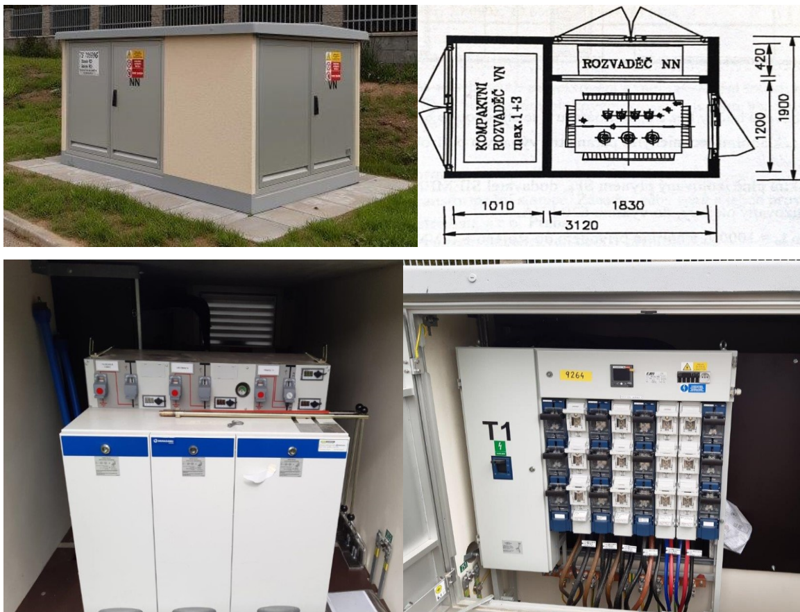
Obr. 2.32 - Kiosková trafostanice s vnější obsluhou do výkonu 1 x 630 kVA, typ UKL 3119, převzato z [46] a [Zdroj: Archiv autora]
