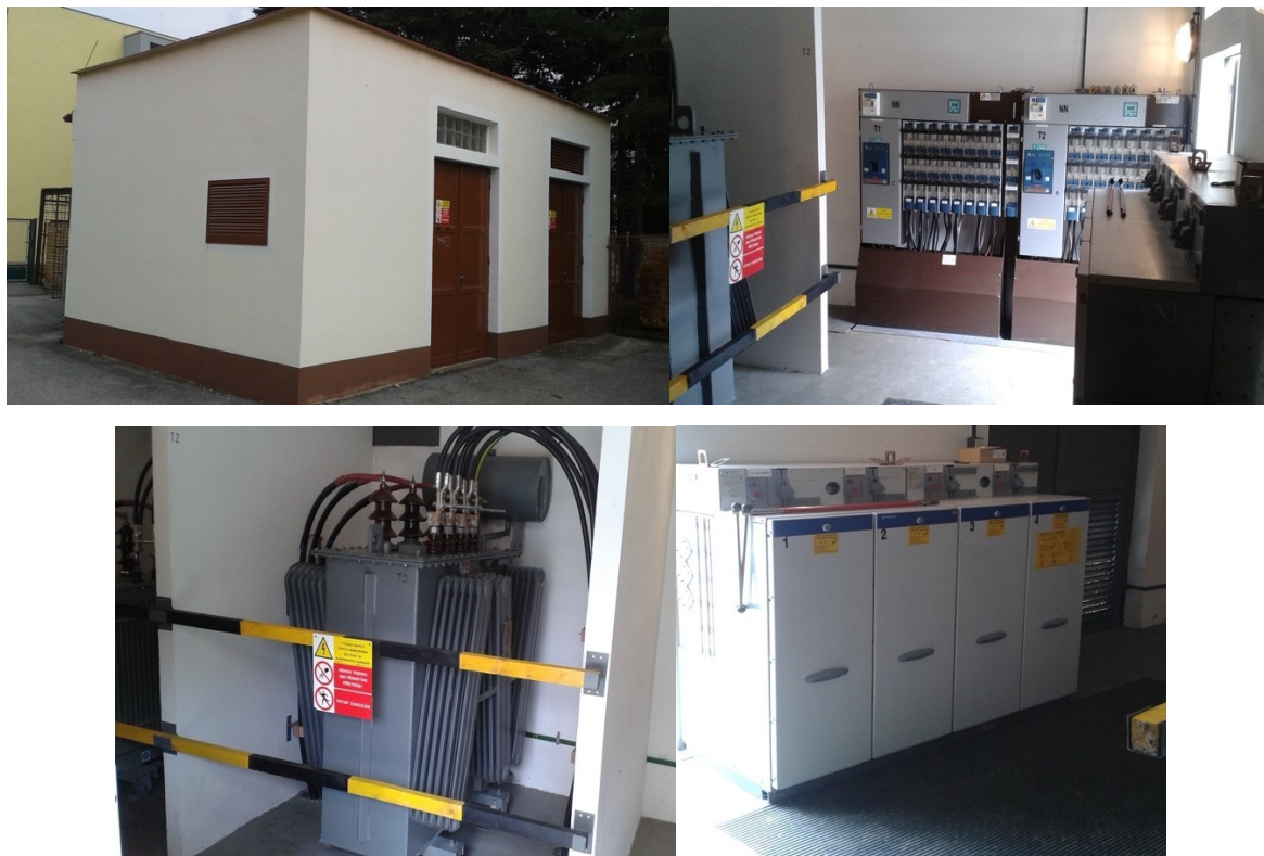
Obr. 2.30 - Samostatně stojící zděná trafostanice s dvěma transformátory, [Zdroj: Archiv autora]
