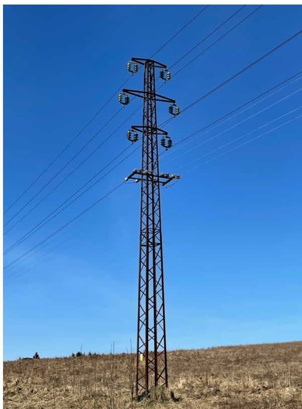
Obr. 2.9 - Příhradový stožár použitý při souběhu vedení VN a NN, [Zdroj: Archiv autora]
