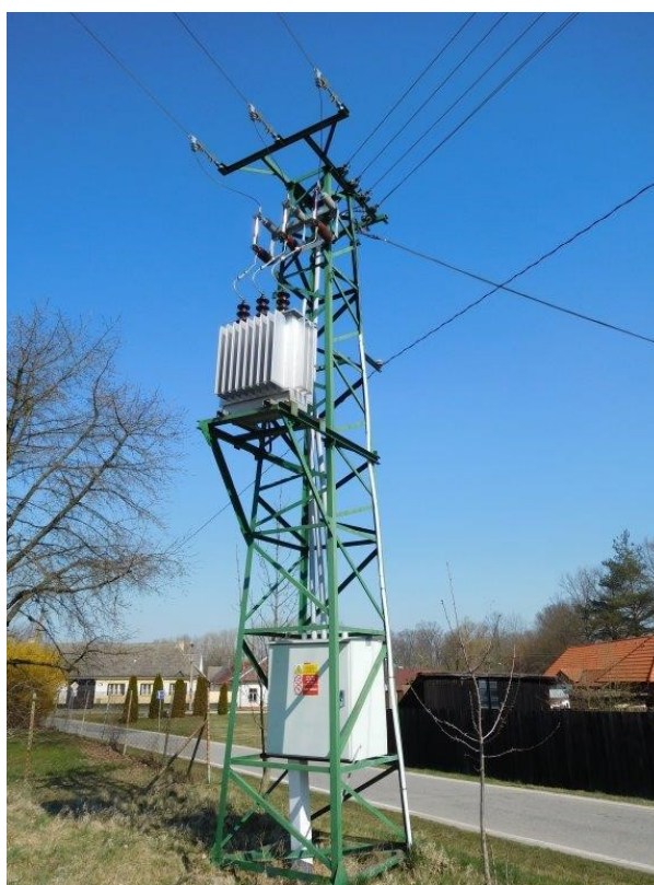
Obr. 2.17 - Příhradová distribuční trafostanice, [Zdroj: Archiv autora]
