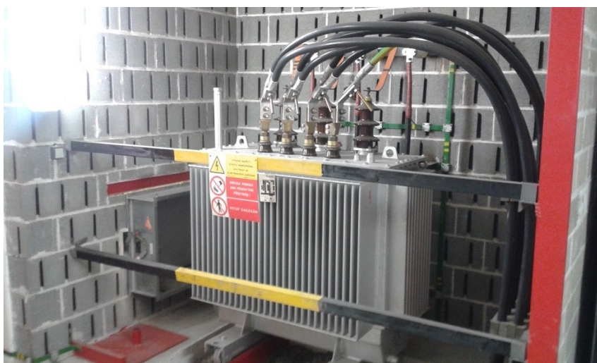
Obr. 2.14 - Hermetizovaný distribuční transformátor, [Zdroj: Archiv autora]
