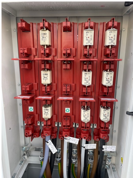
Obr. 2.26 - Rozpojovací pilíř SR522, [Zdroj: Archiv autora]
