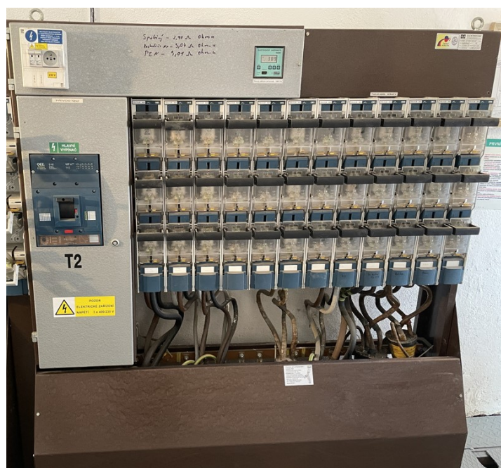
Obr. 2.29 - NN rozvaděč s lištovými odpínači, [Zdroj: Archiv autora]
