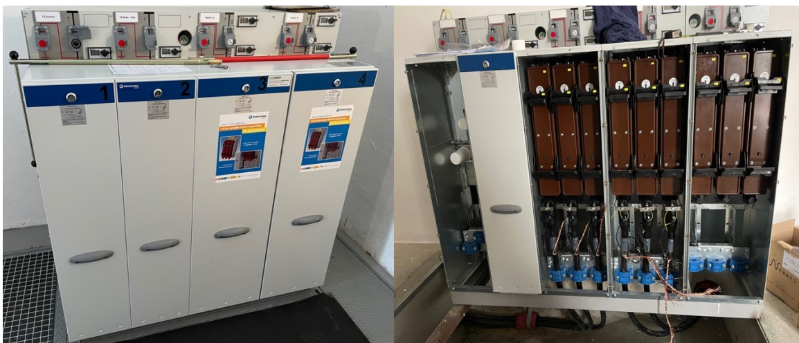
Obr. 2.28 - Kompaktní VN rozvaděč se zhášecím plynem SF 6 , [Zdroj: Archiv autora]
