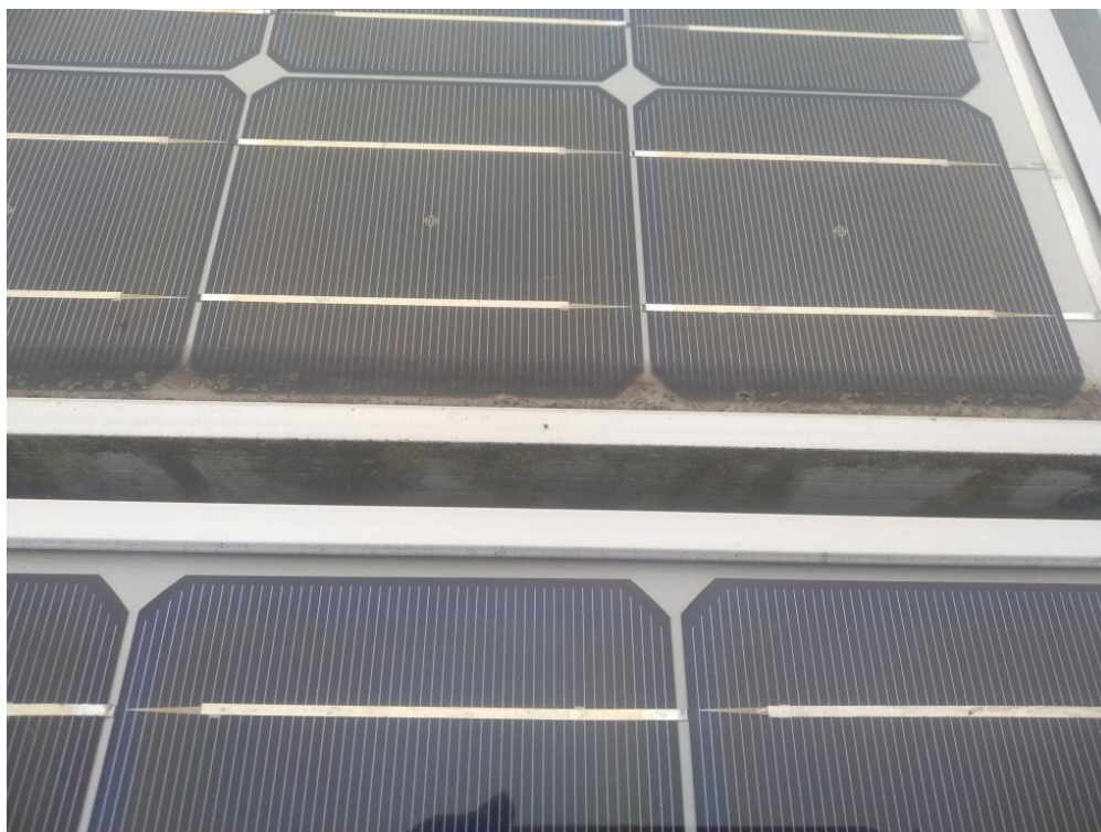
Obr. 3.10 Znečištění panelu analyzované FVE [36]
