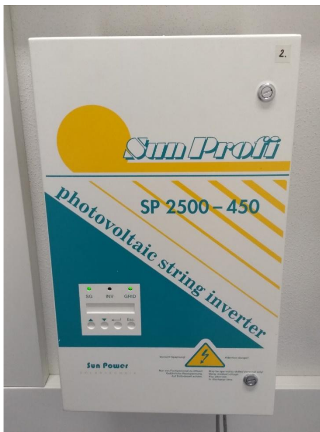
Obr. 1.19 Střídač Sun Profi SP2500-450 analyzované elektrárny
