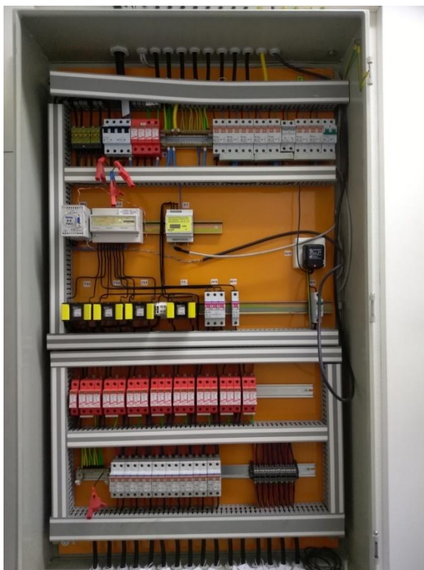
Obr. 1.21 Rozvaděč analyzované elektrárny
