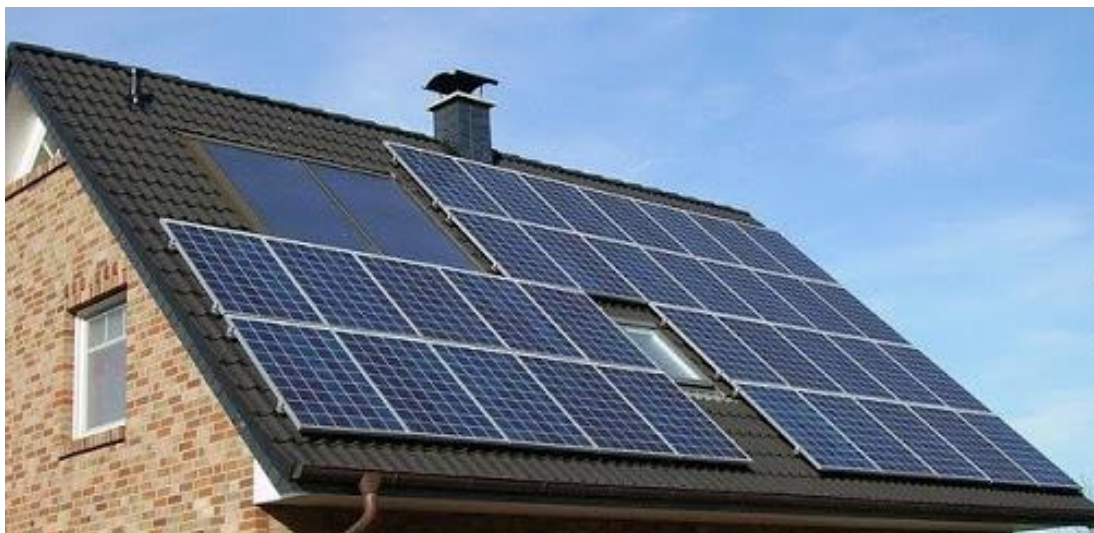
Obr. 1.13 FV panely nainstalované na sedlovou střechu [26]
