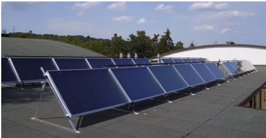
Obr. 1.14 FV panely nainstalované na ploché střeše [27]
