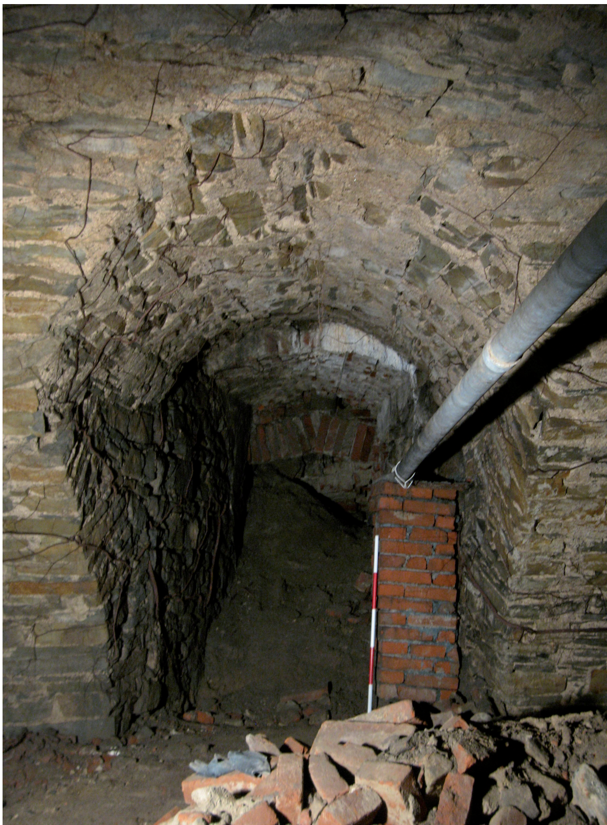
Obr. 24. Holešov zámek. Pozdně gotický suterén před západním příkopem, pohled na niku někdejšího průchodu do části sklepa, odstraněného při hloubení zámeckého příkopu ve druhé půli 17. století. Foto Jan Štětina, 2015. – Abb. 24. Holešov (Bezirk Kroměříž), Schloss. Spätgotisches Untergeschoss vor dem westlichen Graben, Blick auf die Nische des einstigen Gangs, der in einen Teil des bei der Vertiefung des Schlossgrabens in der zweiten Hälfte des 17. Jahrhunderts entfernten Kellers führt. Foto Jan Štětina, 2015.
