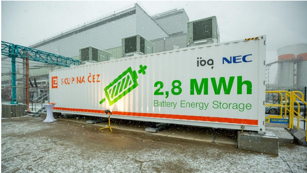
Obr. 16 Velkokapacitní baterie v elektrárně Tušimice II [61]
