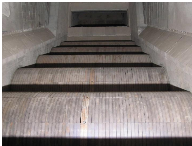
Obrázek 10 Pohled do spalovací komory vybavené válcovým roštem [42]
