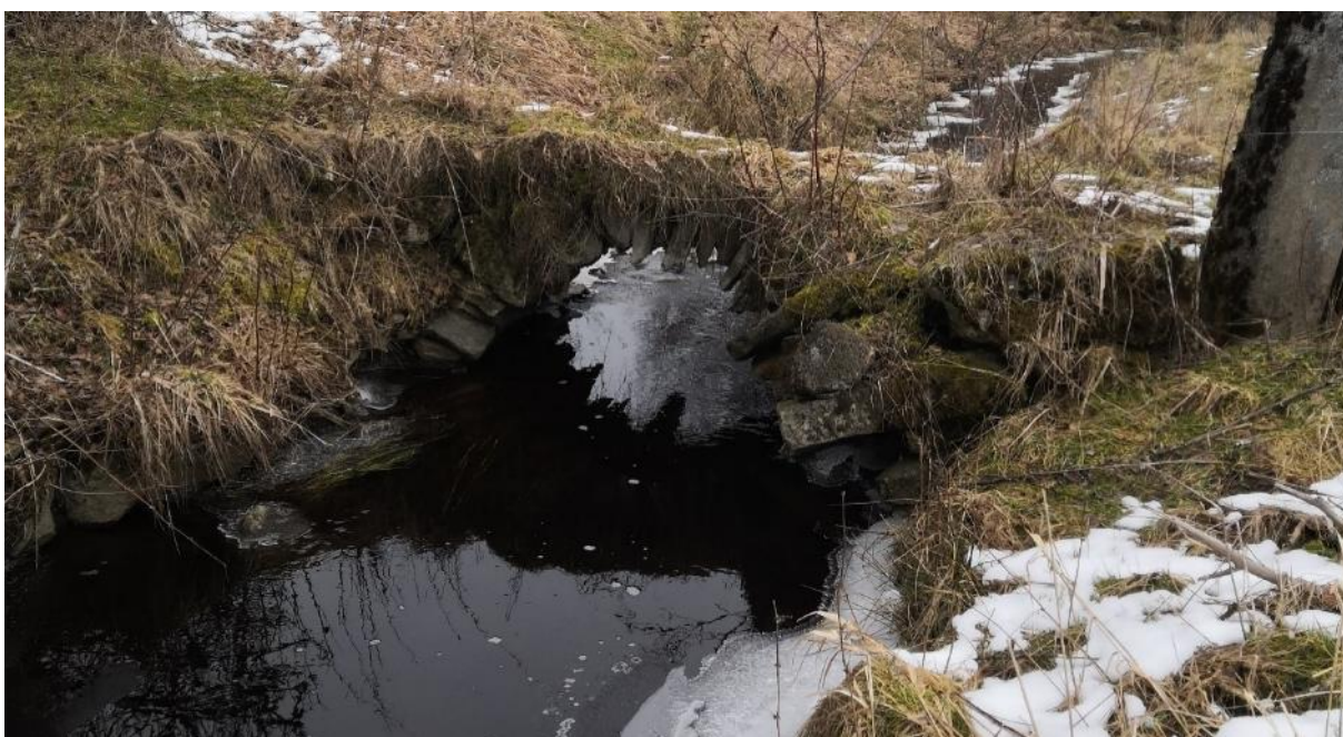
Obrázek 95: O35 – Kamenný obloukový most, poškozený (archiv autora).
