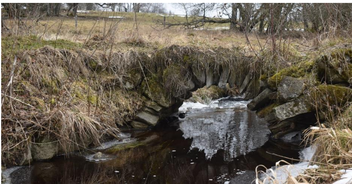
Obrázek 96: O35 – Kamenný obloukový most, poškozený (archiv autora).
