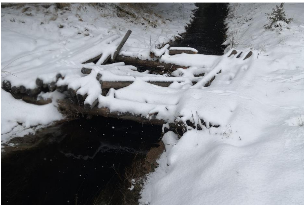
Obrázek 51: O16 – Dřevěný most bez základů, částečně rozpadlý (archiv autora).
