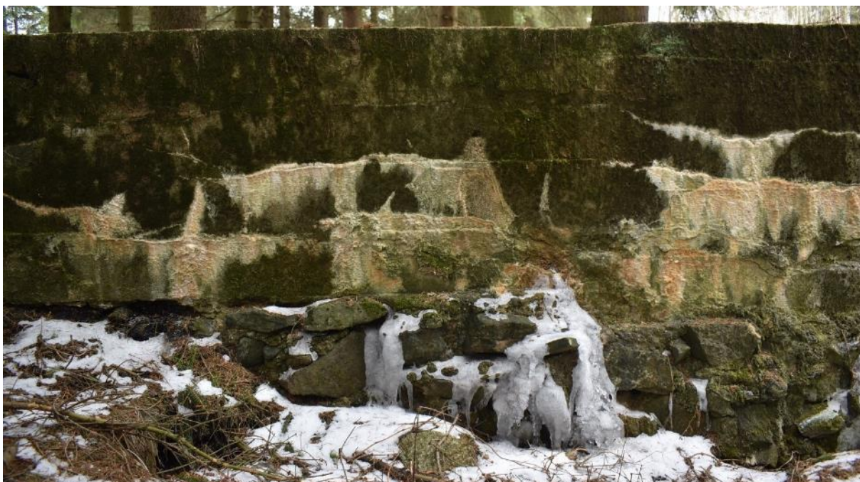
Obrázek 91: O31 – Pravobřežní betonová zeď, detail staré a nové části zdiva (archiv autora).
