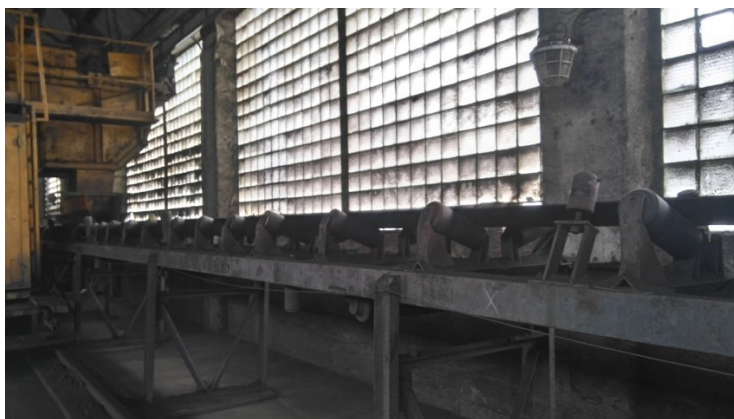
Obr. č. 20: Dopravníkový pás mezi Odležárnou a Jemnou úpravnou
