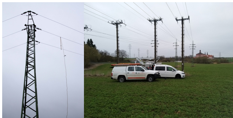
Obr. 23 Umělé kovové zemní spojení, měřicí stanoviště
