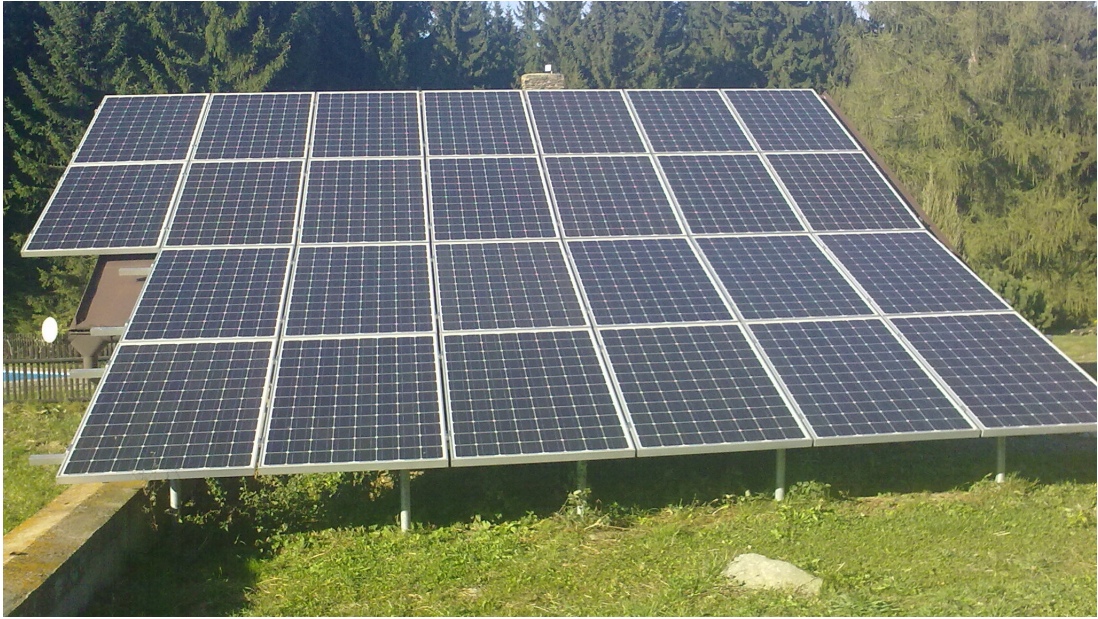
Obrázek 3.2: Fotografie solární elektrárny
