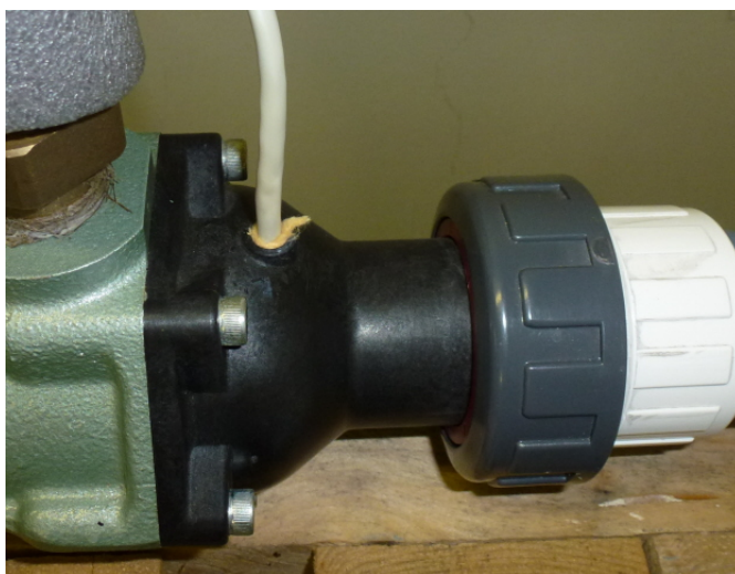
Obrázek 5.7: Detail zapojení čidla ve výměníku ohřevu
