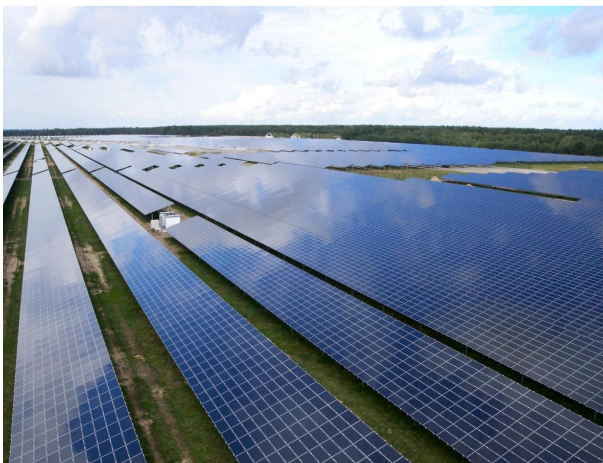
PŘÍLOHA 4 SOLÁRNÍ ELEKTRÁRNA S TENKOVSTVÝMI FOTOVOLTAICKÝMI PANELE [41]
