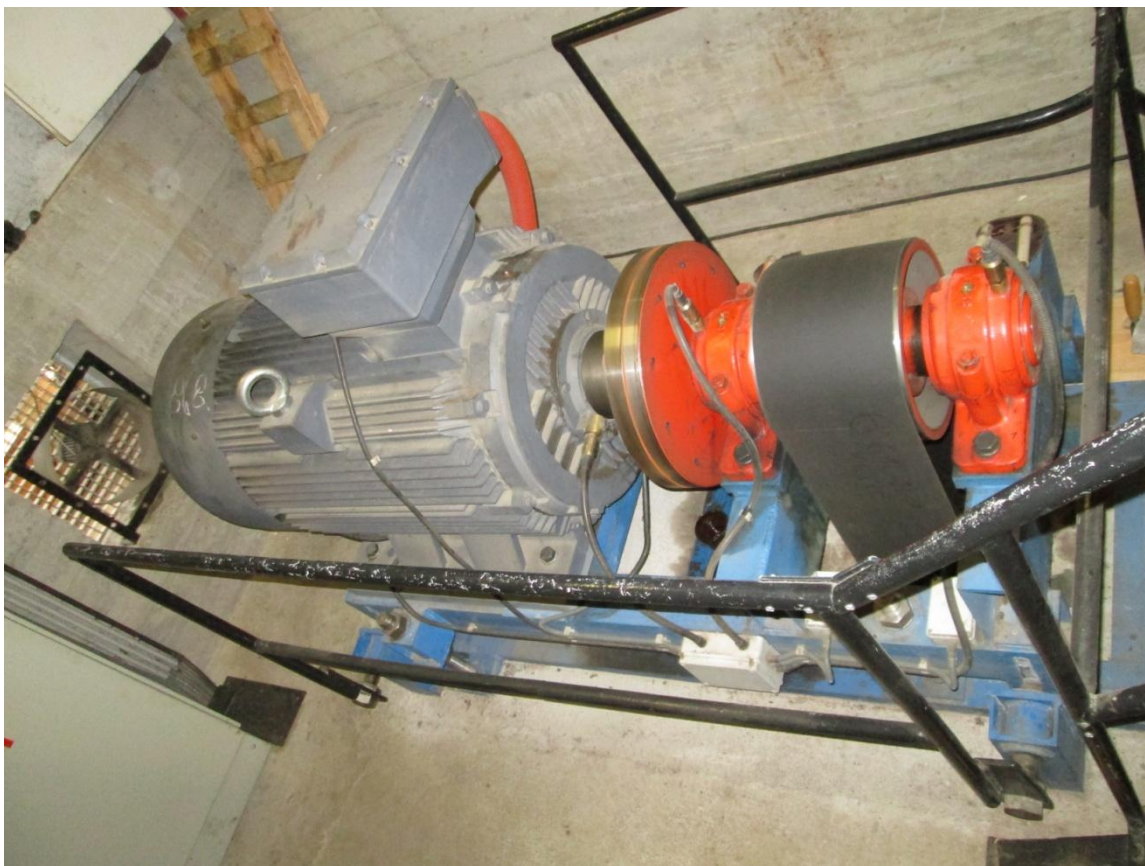
Příloha L Asynchronní generátor (Hydrohrom), stavidlové pole [5]
