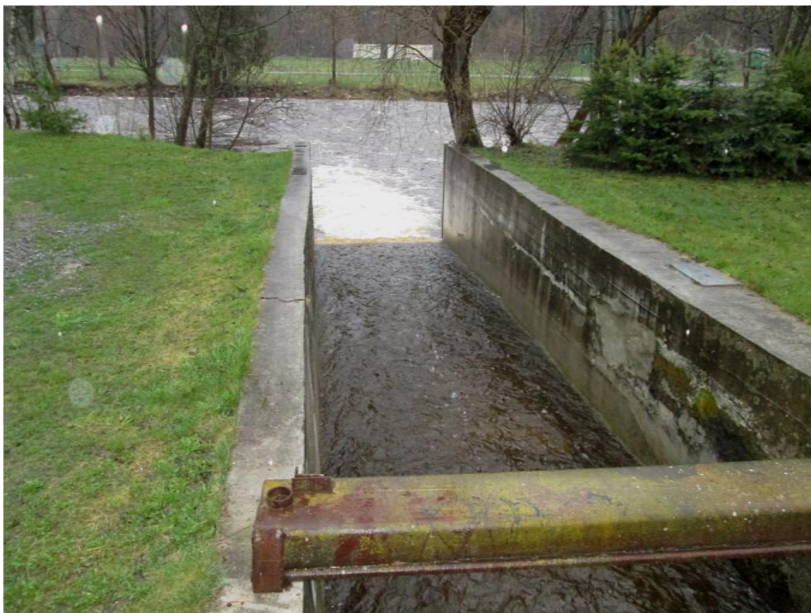
Příloha F Kanál jalového přepadu, vyhřívání [5]
