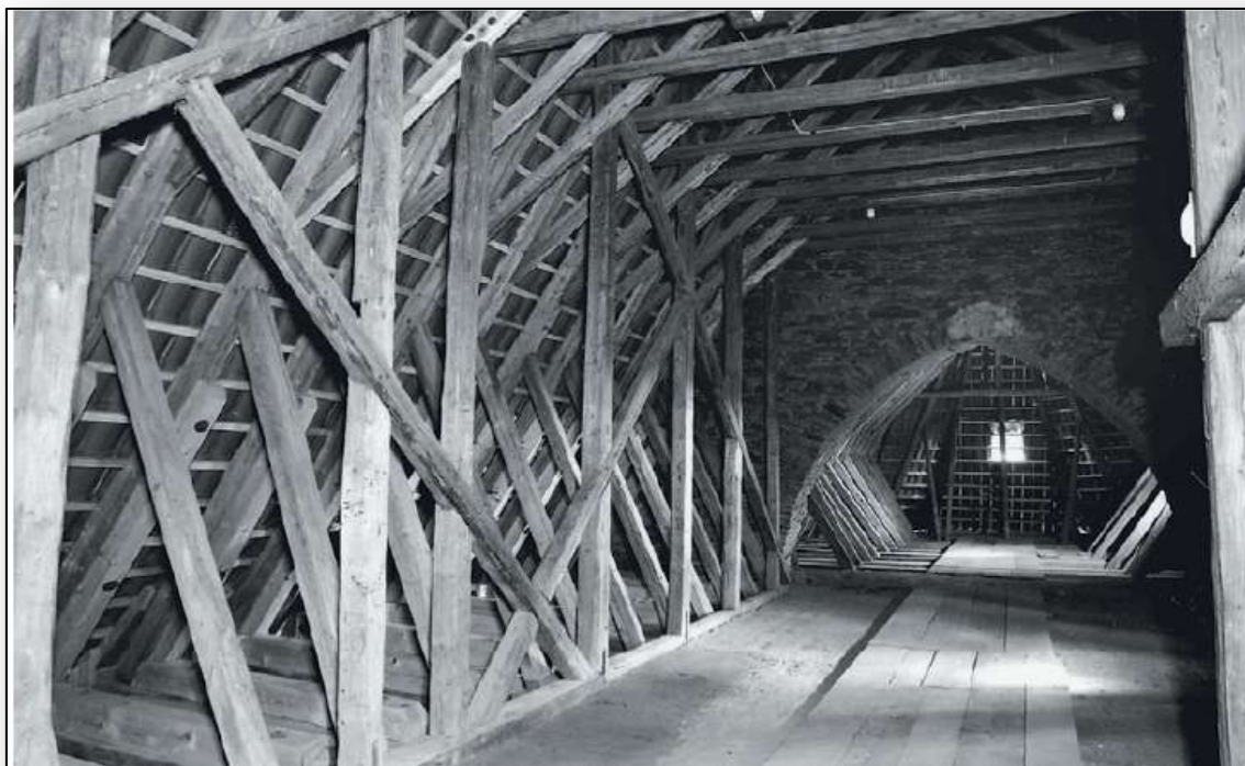
Obr. IX Horšov, kostel Všeoh svatých, průhled krovem nad lodí směrem na východ a do krovu nad presbyteriem. Konstrukce obou krovů kolem roku 1363. 65
